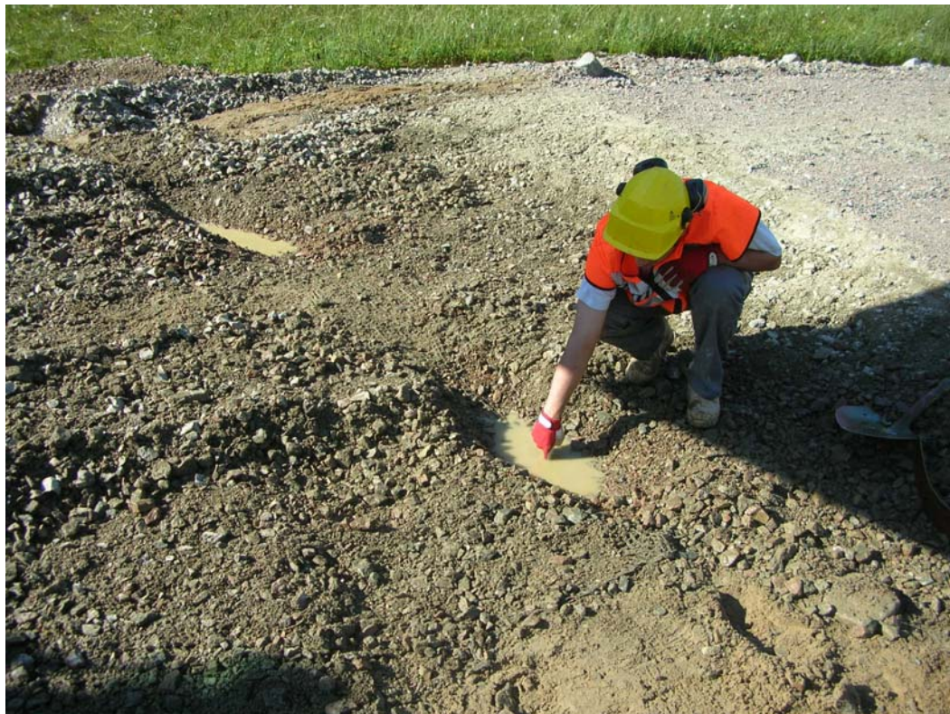
Figur 9: Spordannelse ved armeringsnett, høy vannstand
