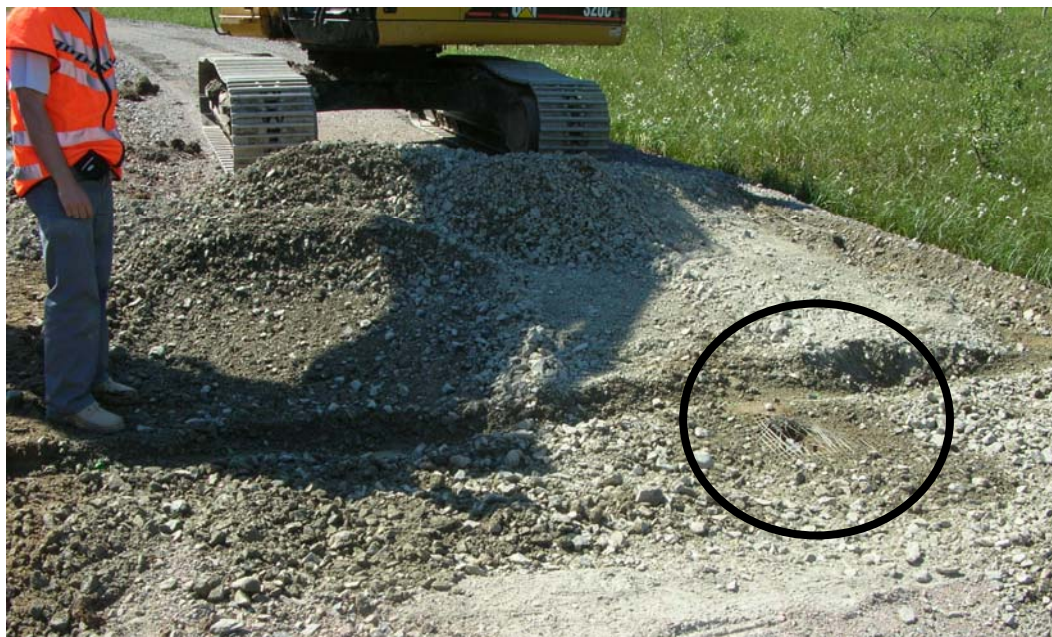
Figur 17: Skade på armering ved frigraving
