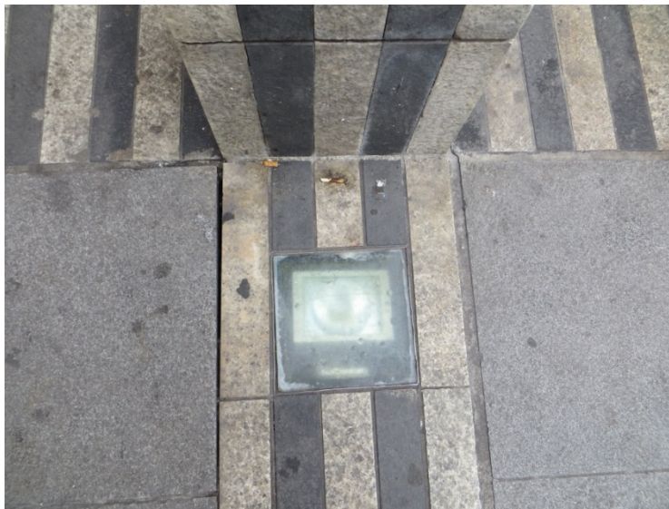
Lysarmatur nedfelt i bakken foran høye søyler på Place de Terreaux.
