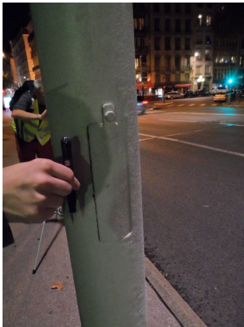
Master med ruglete, matt overflate. Trekkekummer – små og lite gjennomtenkt, mulig kun tenkt som koblingsboks og ikke trekkekum. Små koblingsluker i mastene.
