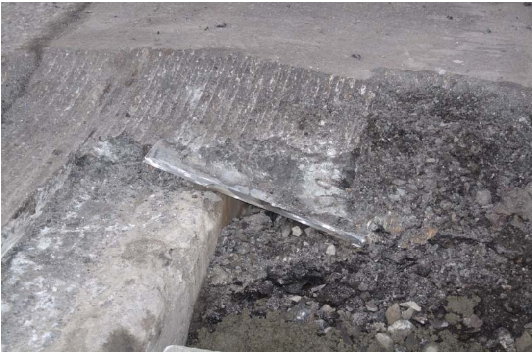
Tollerud Vest: Fugestålet ligger an på brudekket på den ene siden og i komprimert masse på den andre siden. Fugestålet har her vridd seg kraftig.
