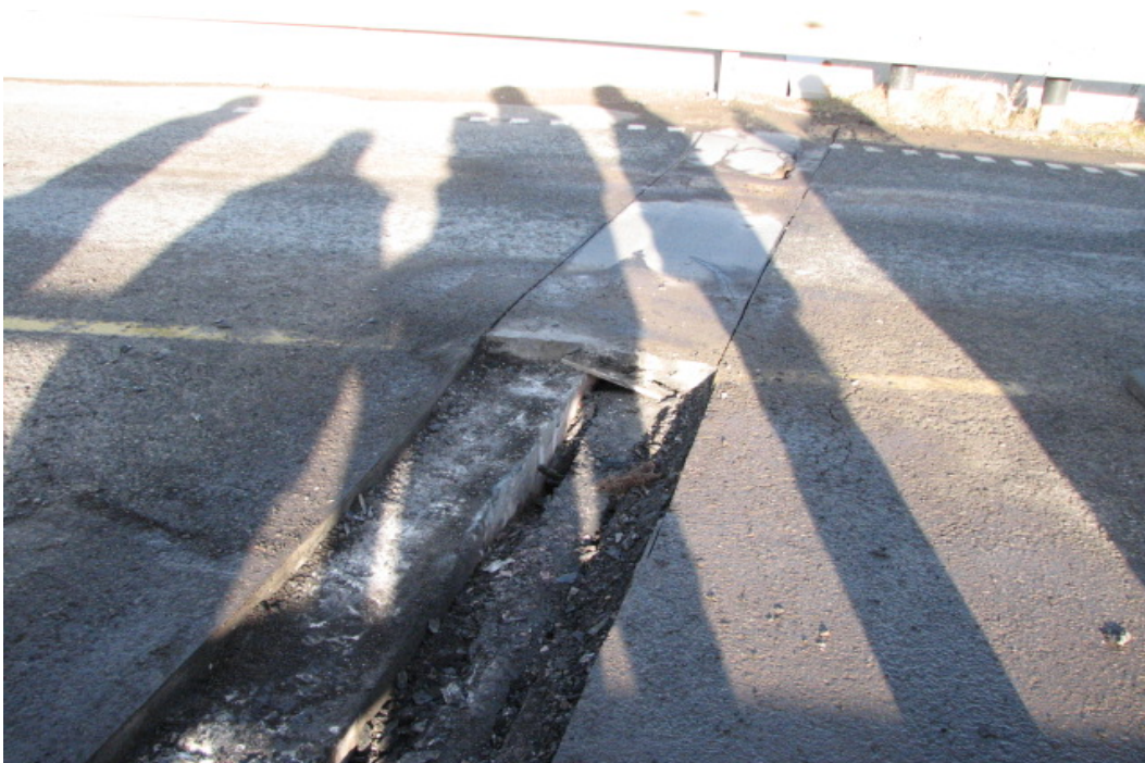
Kopstadkrysset overgangsbru, østre fuge før reparasjon 2007: På landkarsiden har den komprimerte massen gitt etter med det resultat at fugestålet vrir seg og det oppstår omfattende skader i fugene.
