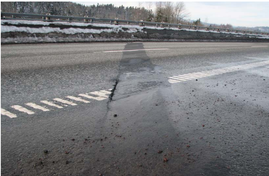
Nøklegård Øst, søndre fuge: Midlertidig reparasjon utført 2008. Fugeplate har begynt å vri seg, det er setninger før brua og sprekker i fugen.
