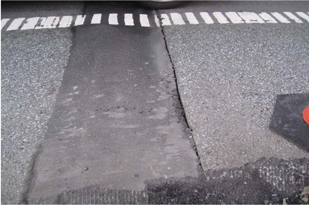
Tollerud Vest: Asfaltfugen umiddelbart før utskiftning. Fuga er ujevn og det har oppstått spekk mellom fuge og asfaltslitelag på tilstøtende veg.
