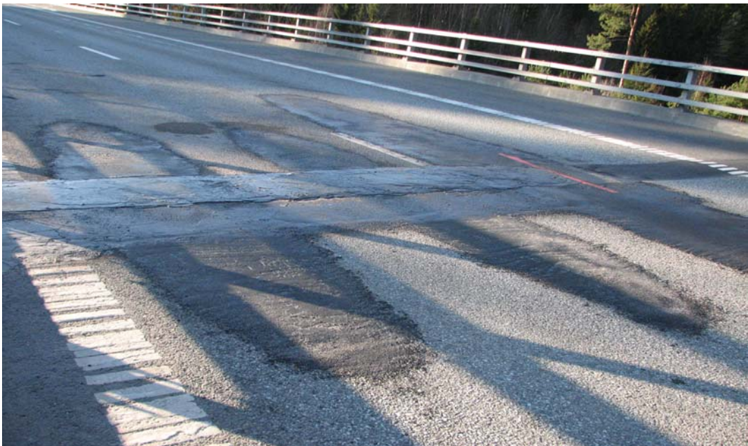
Tollerud Vest: Reparasjonen er ferdig og det er lagt støpeasfalt i hjulspor før og etter fugen.
