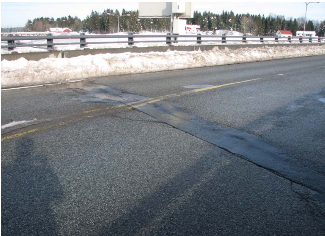
Kopstadkrysset overgangsbru, vestre fuge 18 måneder etter reparasjon: Fugeplaten ble fjernet også her i 2007, men det har oppstått samme setningsproblem som ved østre fuge.
