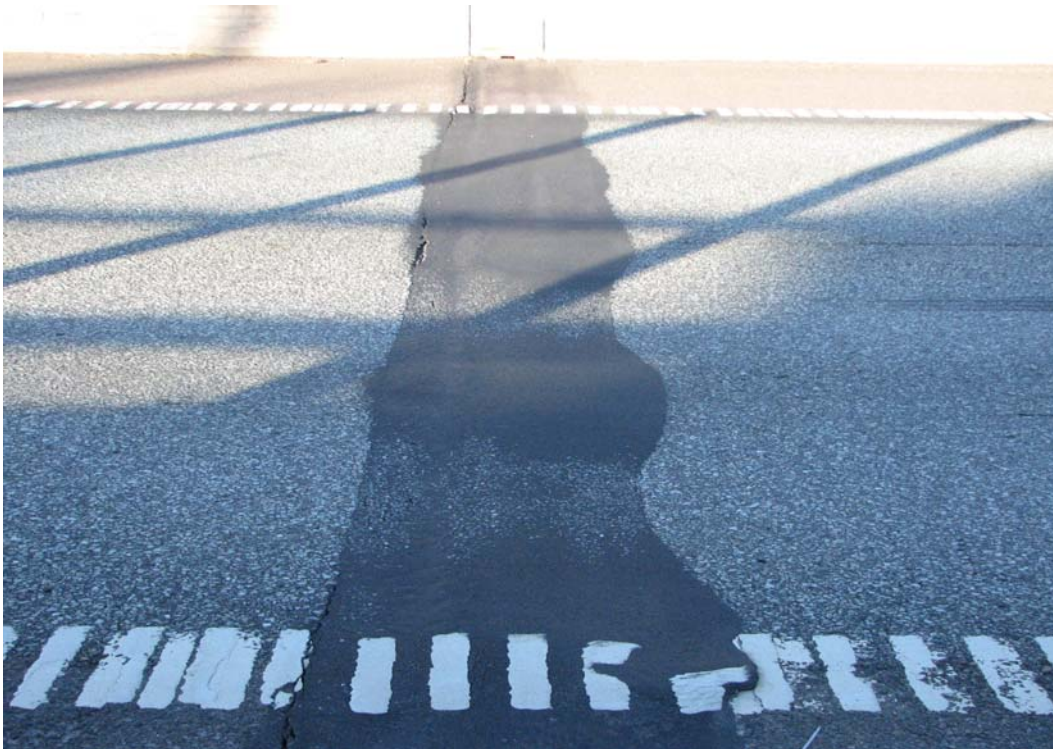
Gilhusdalen Øst, nordre fuge: Asfaltfugen slipper fra slitelaget og fugeplata har begynt å bevege seg.
