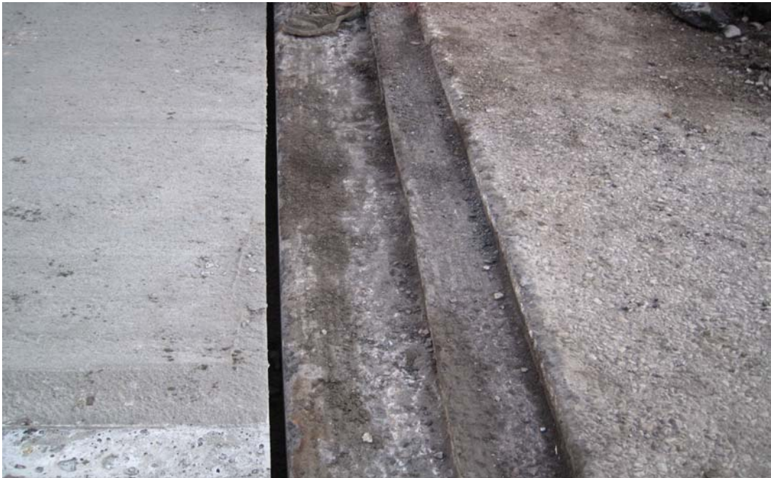
Tollerud Vest: Betongelementene er ferdig lagt. Her vises spalteåpningen mellom betongelementet og brudekke. Nedtrappingen i slitelaget til Tarcofugener ferdig skjært.
