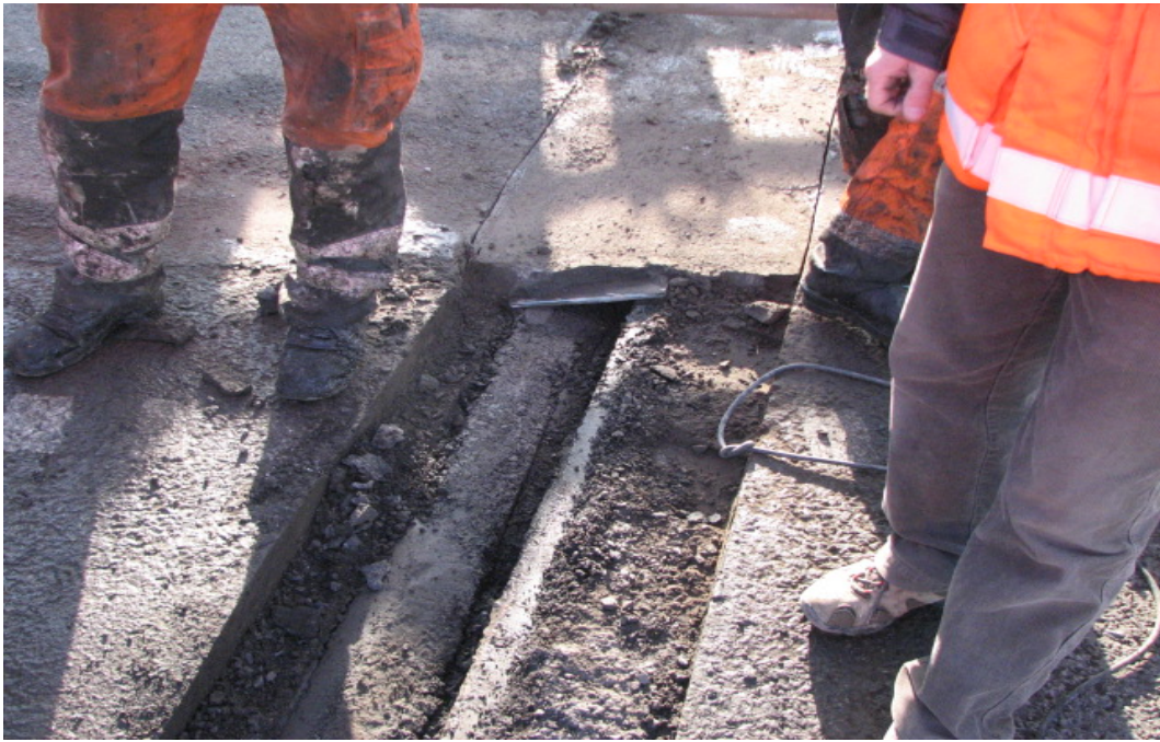
Kopstadkrysset overgangsbru, vestre fuge før reparasjon 2007: Samme problem som ved østre fuge.
