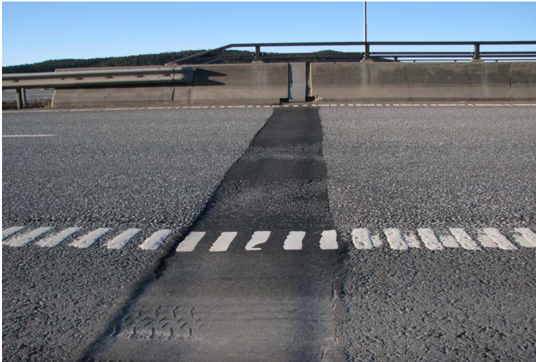
Hvitingsrud Øst, søndre fuge: Fugestålet har begynt å vri seg, men det er kun små sprekker i overgang fra fuge til slitelag.
