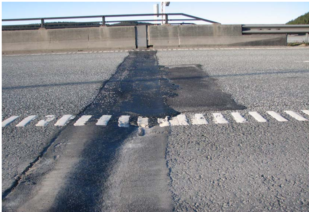
Hvitingsrud Øst, nordre fuge: Fugestålet har tydelig vridd seg og sprekker har oppstått. Fugen ble utbedret i begge kjørefelt høsten 2007.
