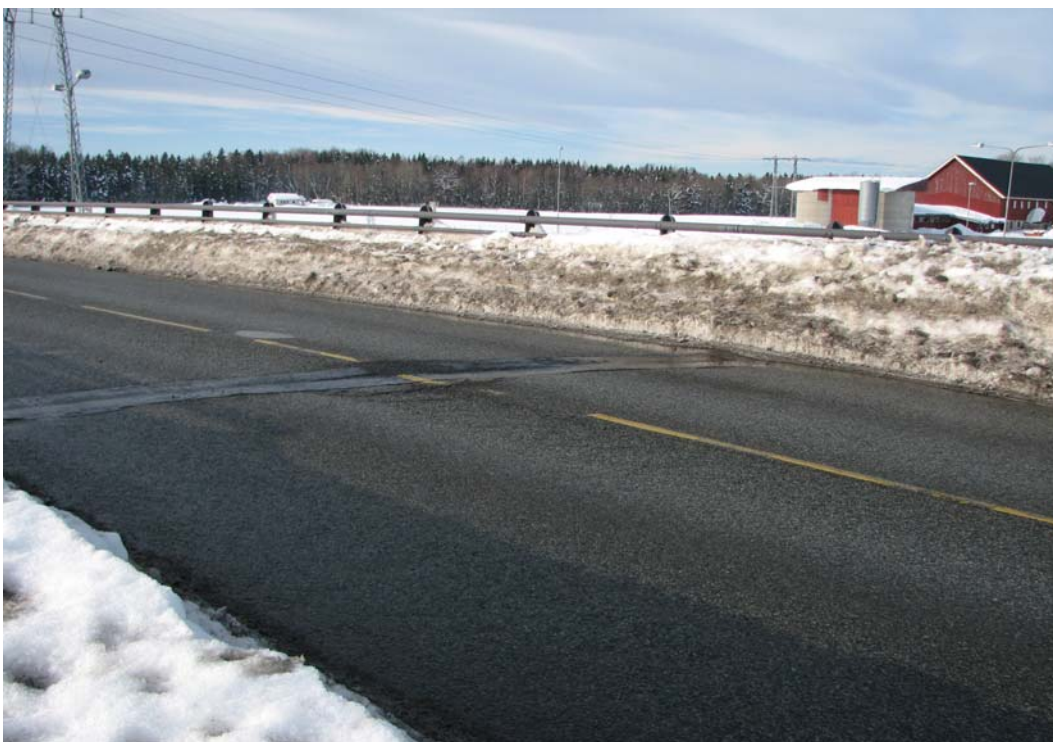
Kopstadkrysset overgangsbru, østre fuge 18 måneder etter reparasjon: Fugeplaten ble fjernet i 2007, men på nytt har det oppstått setningsproblemer.
