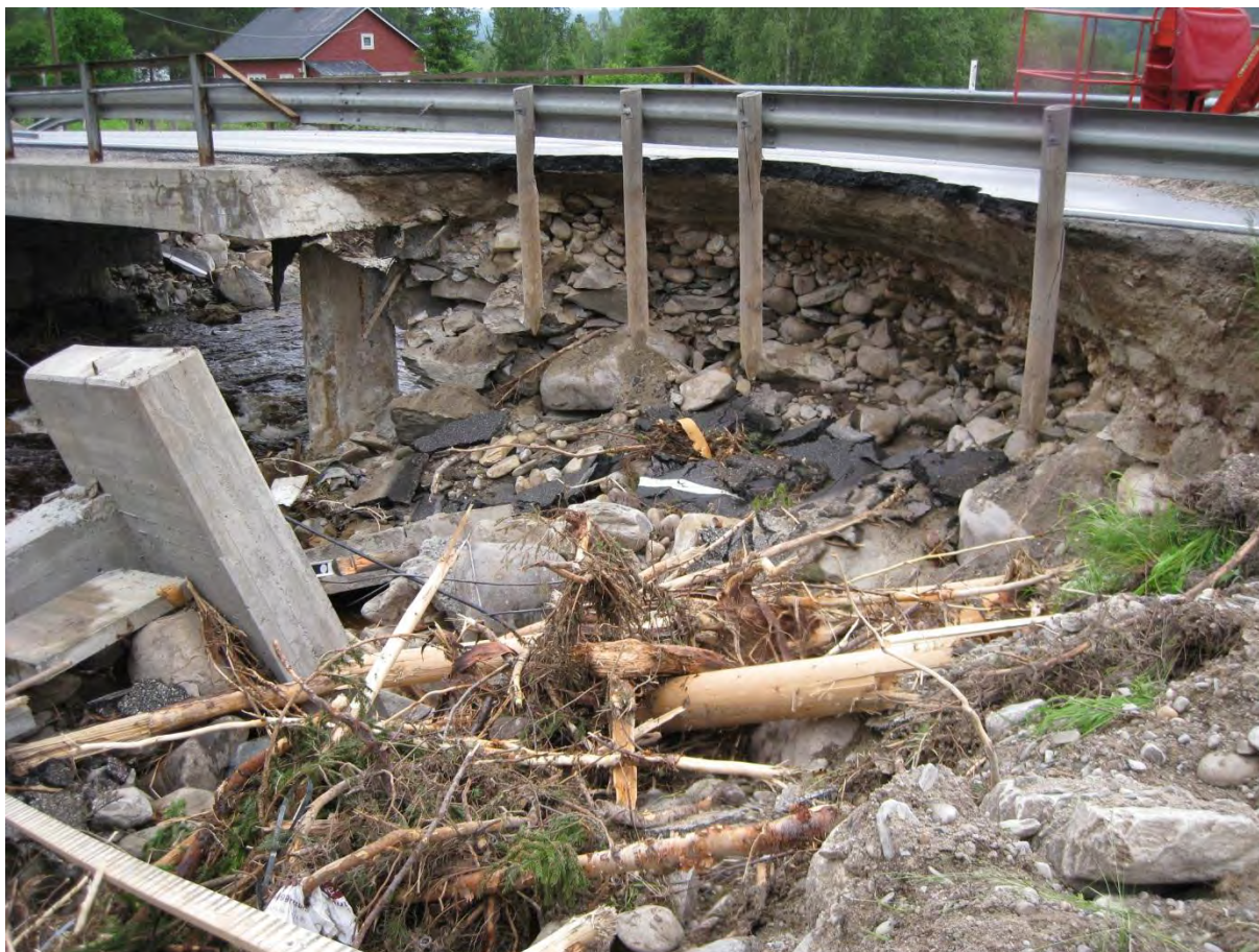
Skader på Trya bru på rv.3 ved Trønnes. Foto: Per Klomstad, Svv.
