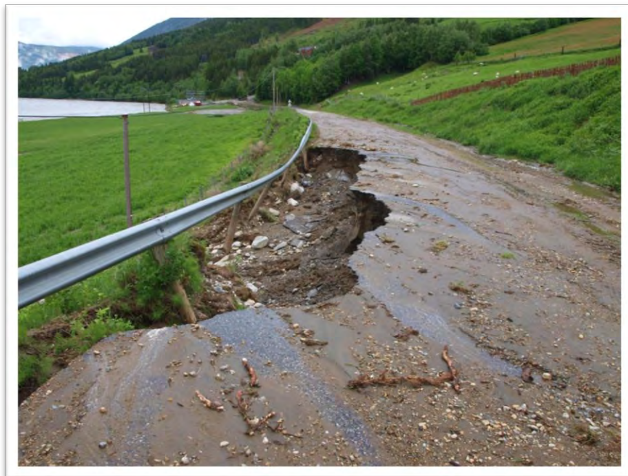
Typisk flomskade på vegnettet. Her fv. 410 mellom Kvam og Vinstra i Foto; Vegavdeling Oppland, Svv.
