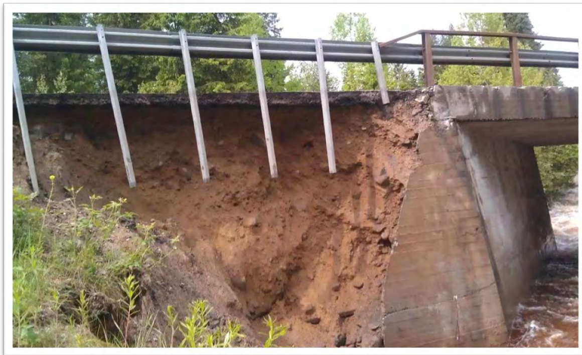
Søndre Bjøråa bru på rv.3. - vinge-støttemur har falt ned (denne skaden kunne fort ha ført til stengt veg) Foto Sindre Bakke. Svv.
