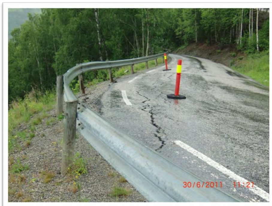
Typisk skade som ikke førte til stengt veg, men som krever tiltak. Her fra Fv. 444 i Oppland mellom Otta og Mysusæter. Foto: vegavdeling Oppland, Svv.
