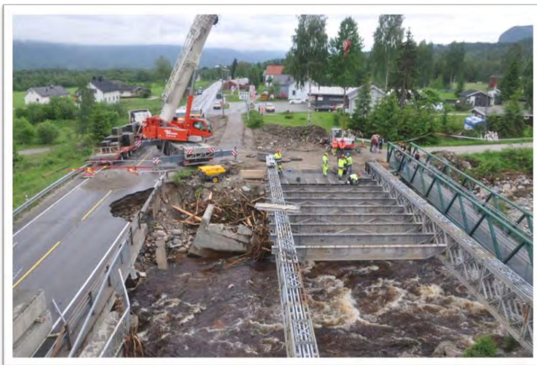
Midlertidig bru under bygging på Rv.3 ved Trønnes. Foto: Håkon Aurlien, Svv
