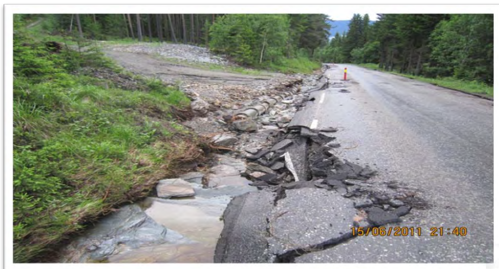
Typisk vegskade under flommen Her fv. 255 i Oppland. Foto: Vegavdeling Oppland
