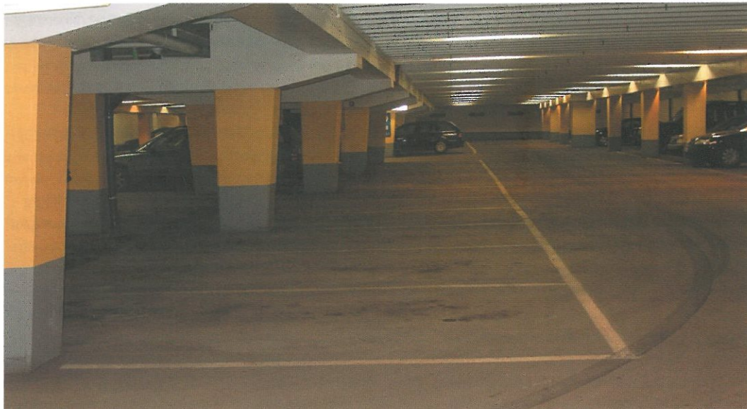
Armaturene er plassert mellom ribbene i dekkeelementene. Belysningen blir derfor begrenset. Fargebruken er riktig.
