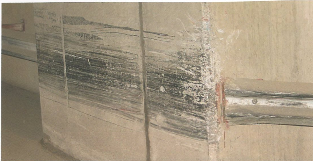
Trange kjørebaner foranlediger skader. Denne utstikkende søylen har hatt mange "besøk".
