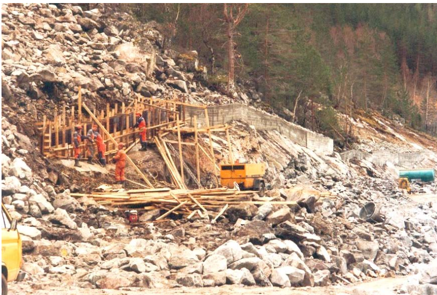
Fig. 20: Permanent sikring med betongmur, rv. 53 Naddvik-Fodnes, Sogn og Fjordane. (Foto E. Husabø, vegkontoret i Sogn og Fjordane.)
