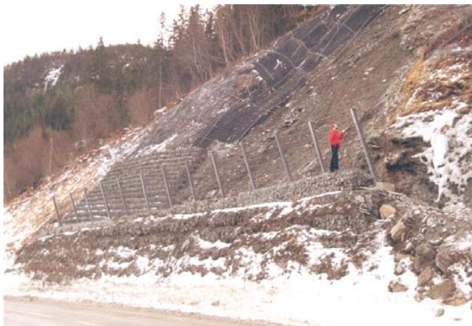
Fig. 9: Ras i ur ved Trolla, Byneset, Sør-Trøndelag. Rasstedet er sikret med gabionmur, steinsprangnett montert på stolper og ubåtnett. Under ubåtnettet var det lagt fiberduk som erosjonssikring.
