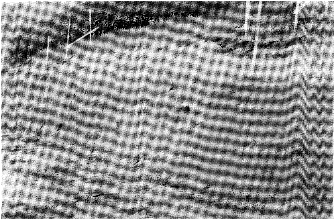
Bilde 2 Utgraving for første stegrad foretatt. Blottleggingen ga veldig god oversikt over grunnforholdene.
