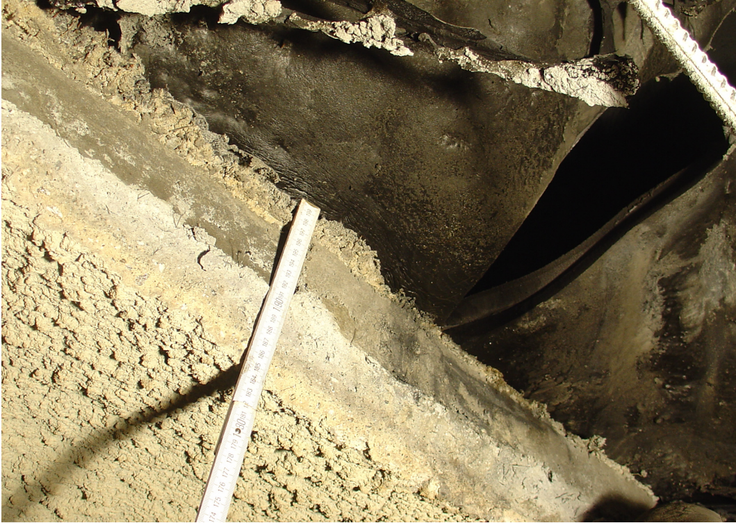
Figur 12 Detalj som viser nesten upåvirket PE-skum på baksiden av ca 15cm tykk sprøytebetong fra det mest temperaturpåkjennte området.
