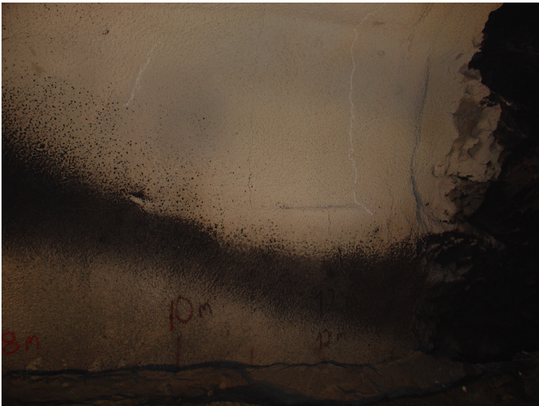
Figur 7 Sprøytebetongfeltet etter brannen. Bildet er tatt på venstre side nedstrøms ende. Overgang mellom lyst og mørkt parti.
