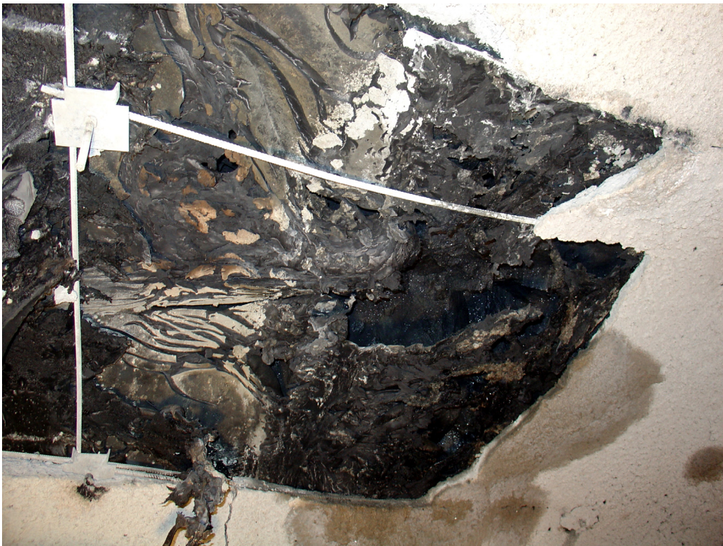
Figur 11 Nedpigget sprøytebetong i området med hulrom bak PE-skummet. Sprekk i nedkant av bildet er ved X=8,3m. Legg merke til brun farge på brent/smeltet PE-skum i kontaktflaten mot sprøytebetongen
