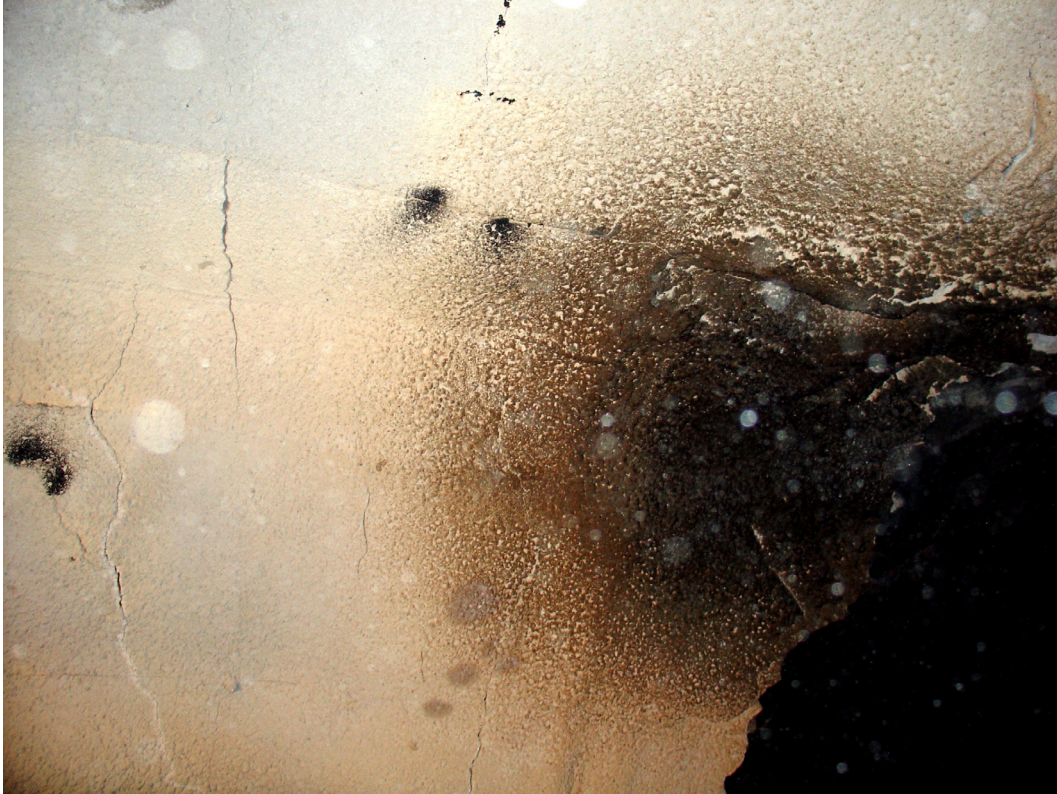
Figur 8 Område med smeltet betong (til høyre i bilde). Store sprekker i sprøytebetongen (til venstre). Lyse "flekker" er støv på linsen (!).
