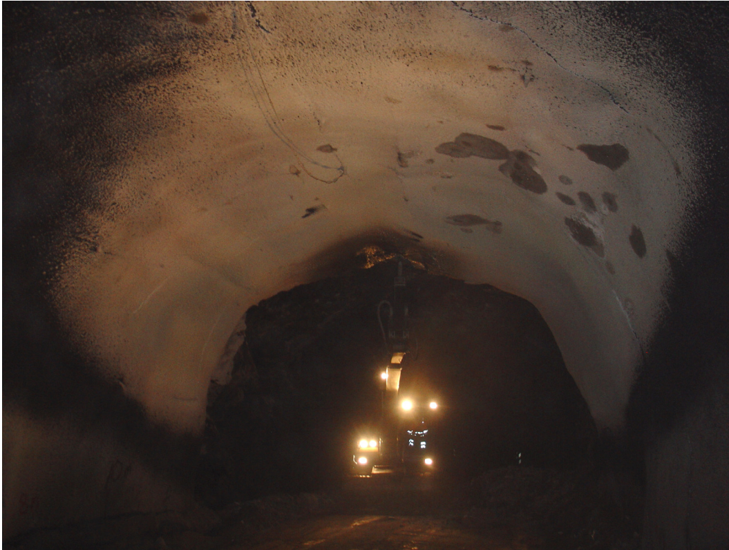
Figur 6 Sprøytebetongfeltet etter brannen. Bildet er tatt i nedstrøms retning. Gravemaskin i ferd med å pigge opp området med smeltet betong.
