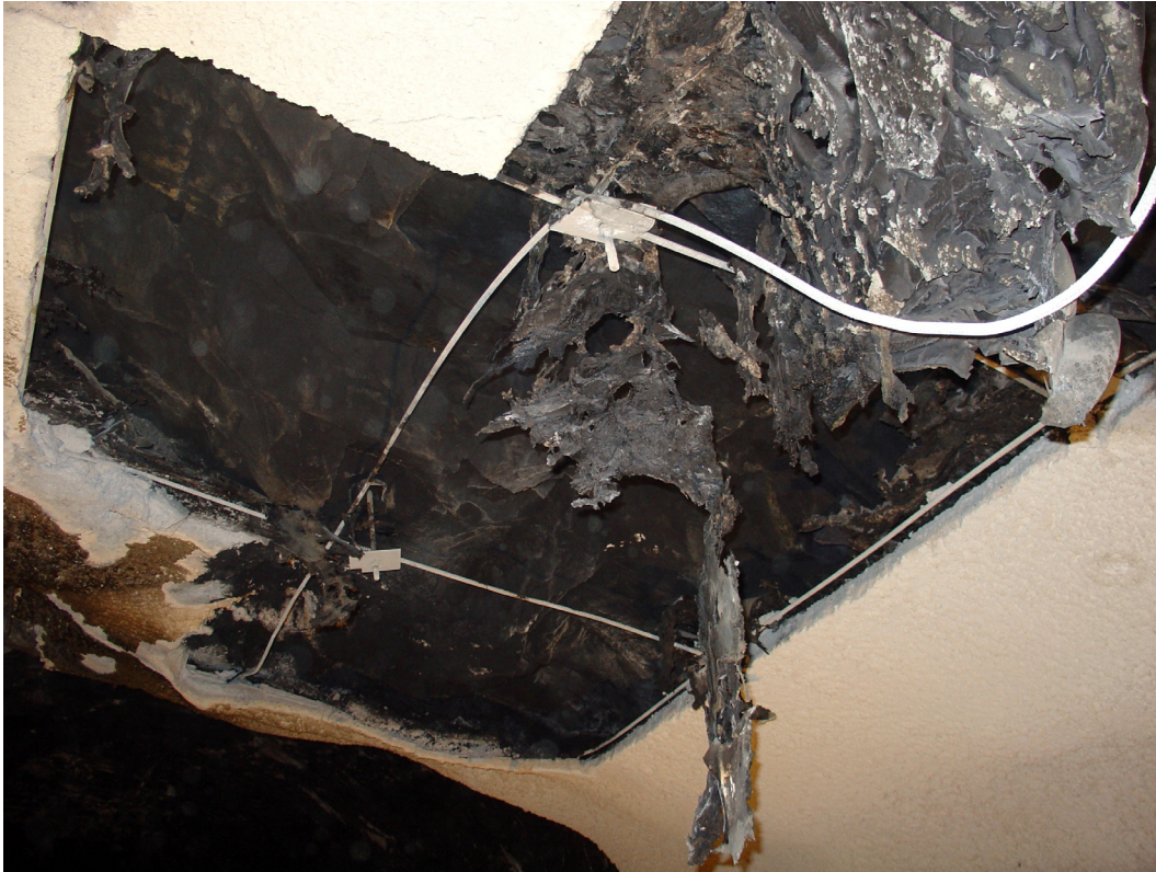
Figur 10 Nedpigget sprøytebetong i området med hulrom bak PE-skummet. Feltet med smeltet sprøytebetong nede i venstre del av bildet
