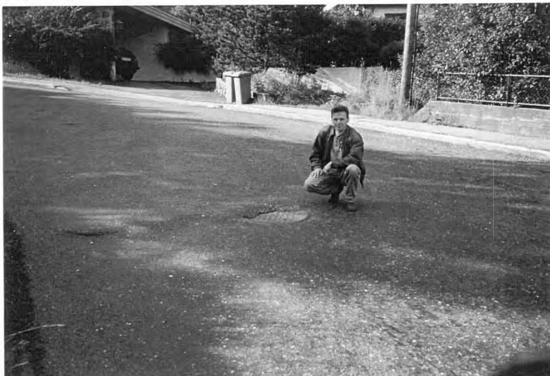
FIGUR 48 Deformasjonsskader på nytt Gja-dekke, Natlandsfjellet i Bergen
