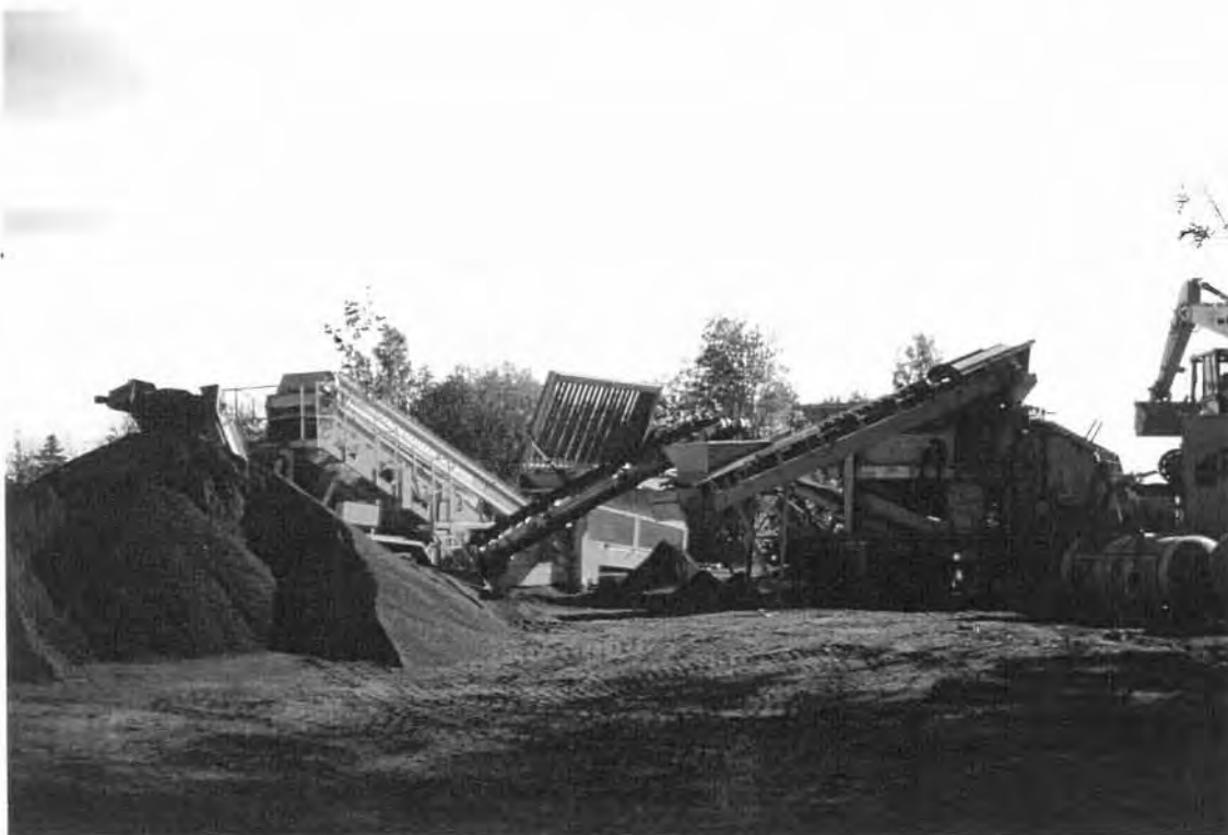
FIGUR 17 Oppstilling av knuseverk ved Ottarsrud
