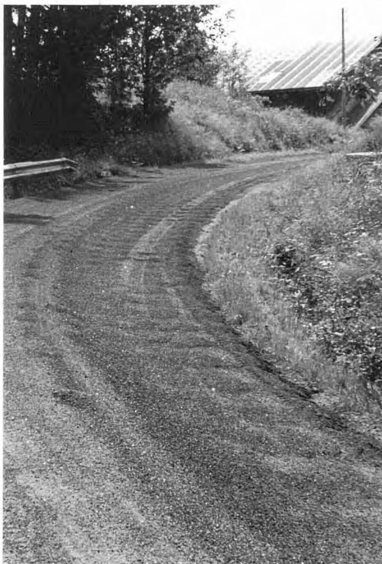
FIGUR 35 Opprettingslag av uanrikt 0-8 mm knust flakmasse, Fv 209 Vestfold. Eksempel på vaskebrett-dannelse i de krappeste kurvene og bratteste bakkene
