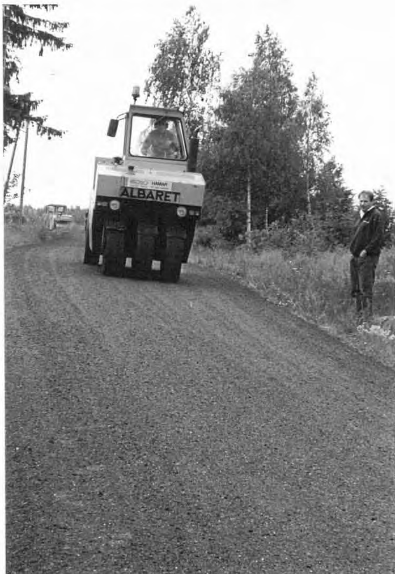
FIGUR 39 Kompaktering av Gja-dekke, Fv 560 Vestfold. Bruk av gummihjulsvals med påfølgende glattvalsing med stålvals
