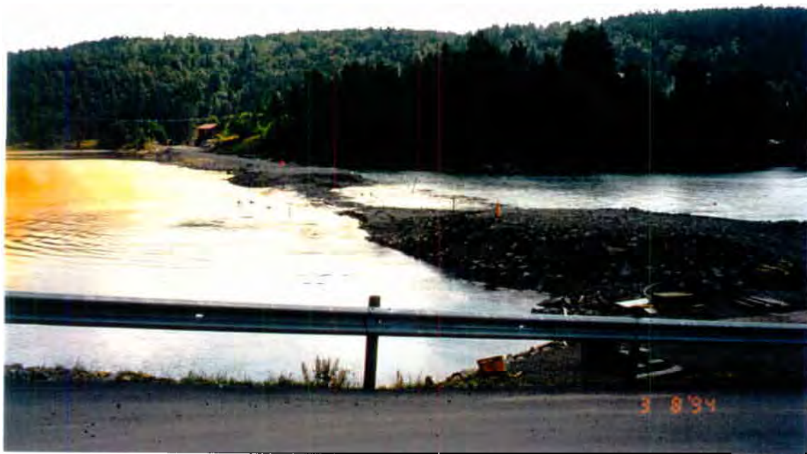
Figur 10. Umiddelbart etter sprengning. Midtre del av fyllingen har sunket 1-2 m og ligger omtrent i vann-nivå. På grunn av skråningsutslaking har den sunket noe mer på sidene. (Foto: Frestad/Pedersen, Statens vegvesen Vest-Agder)
