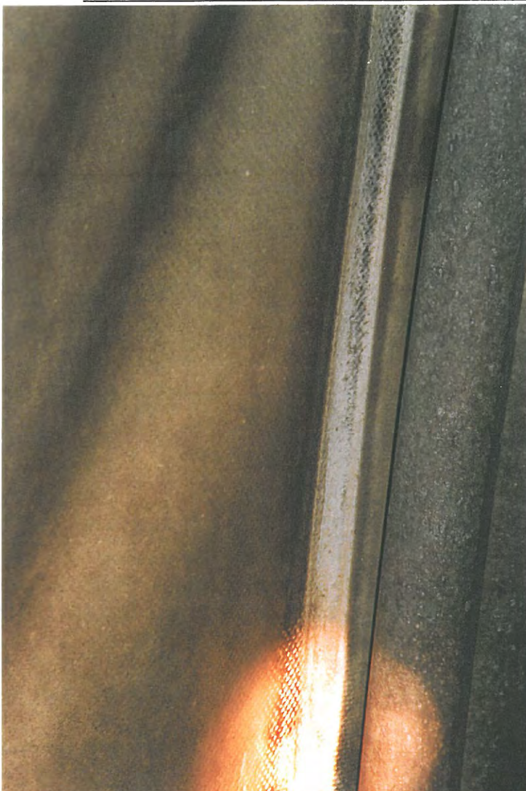
Foto 11 (til venstre) Tunneldukens tilstand rundt rørbue.
