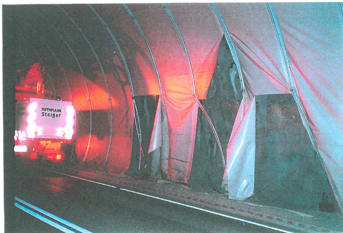
Foto 14 Tunnelduk av samme type (WG-T100) er montert i Hvalfjordur tunnel på Island. Bildene 14 - 16 viser skadene på duken etter en påkjørsel tidligere i år. (Foto: Thor Gunnarsson).
