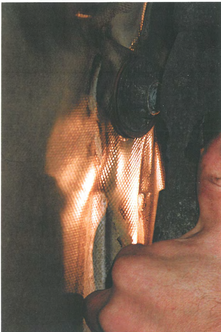
Foto 9 (til venstre) Samme som foto 7. Ingen tegn til skader i den armerte duken. Kun rustavleiringer rundt boltene.
