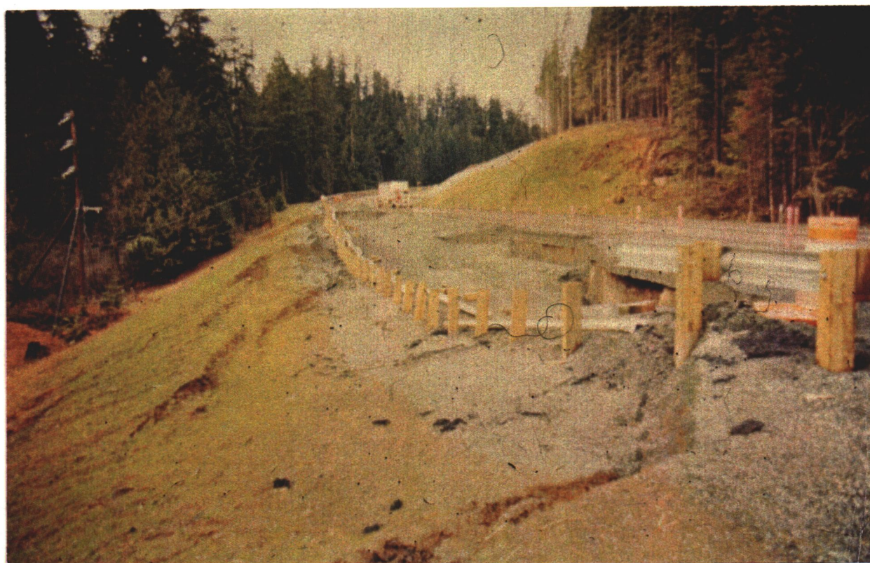
Figur 10. Skråning før utbedring
