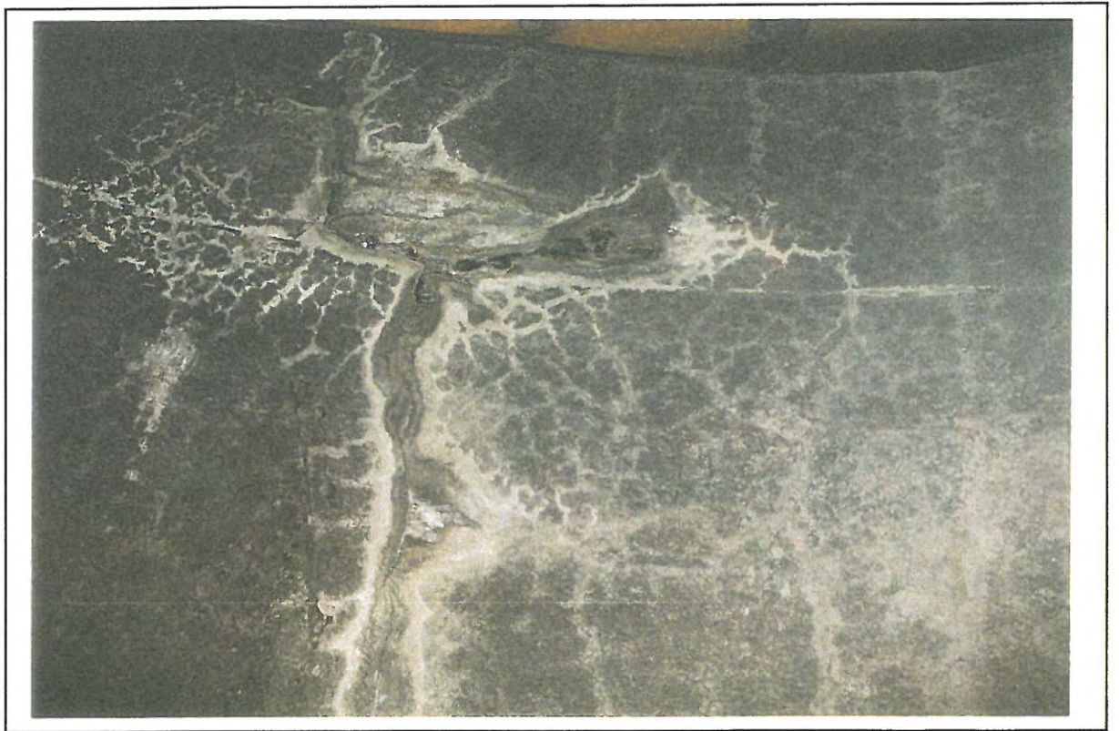
FOTO 10 Holmestrandtunnelen 1/4 97: Plasstøpt betonghvelv med oppsprekking og kalkutfelling.
