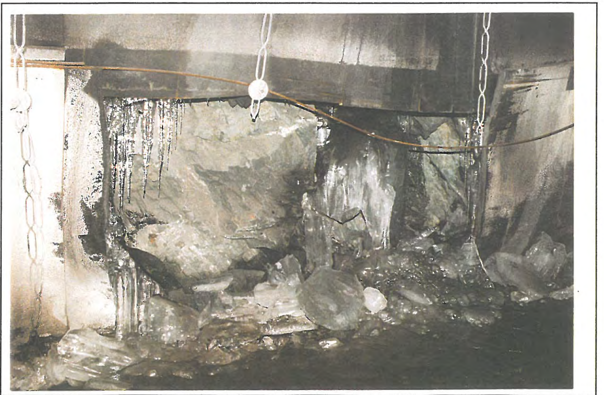
FOTO 12 Austmanalitunnelen 13. febr. 1997: Detalj fra foto 10. Skadet PE - Skum med lekkasje og issvuller ut i vegbanen.
