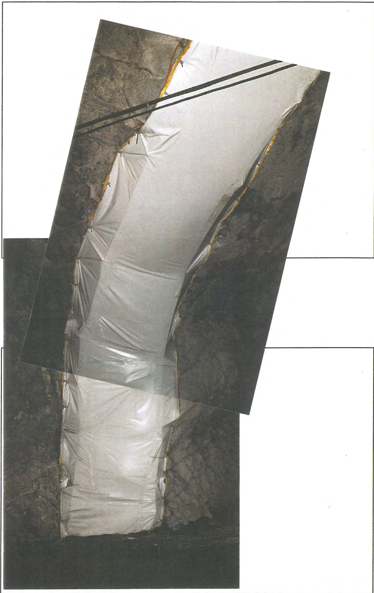
FOTO 16/17 Austmanalitunnelen 13. febr. 1997: Punktlekkasje sikret med isolert WG - duk. Merk at svikt i sveis fører til liten lekkasje midt på bildet. (Reklamasjon) .
