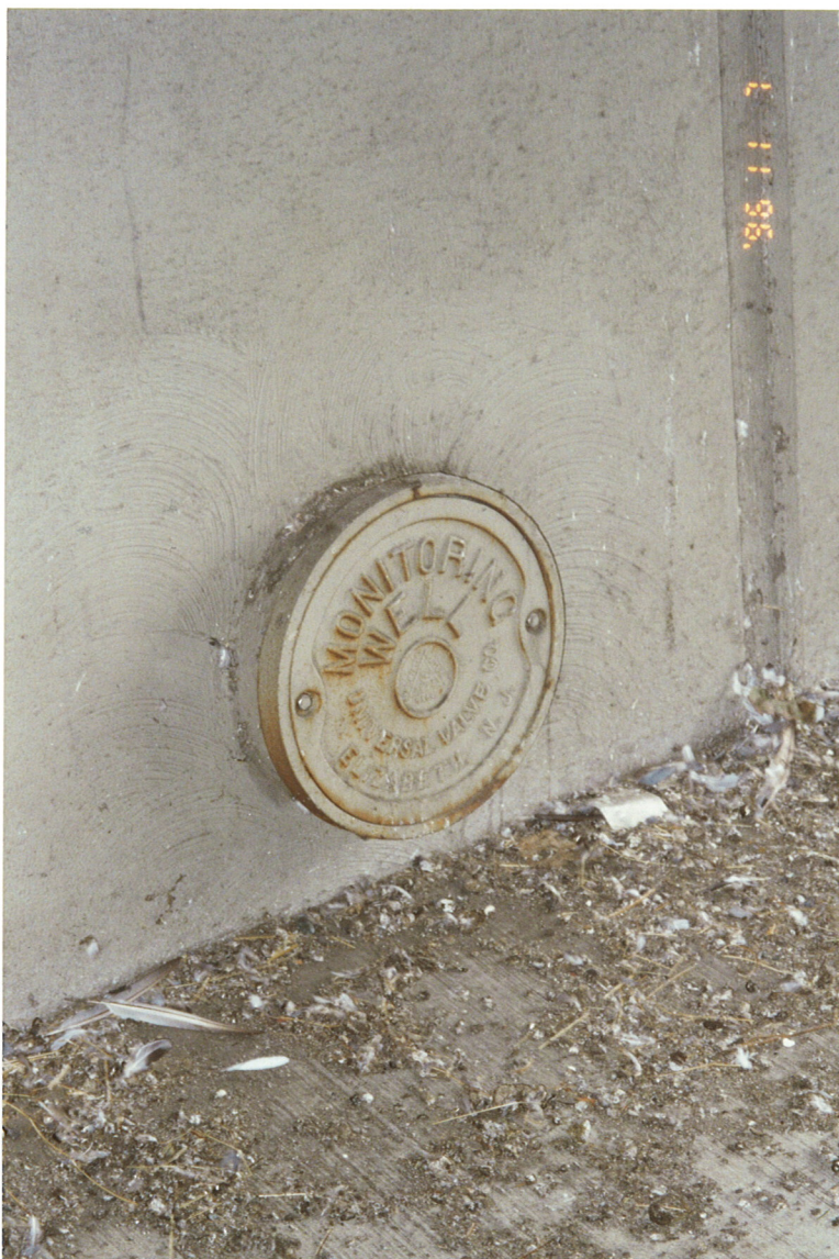
Bilde 23: Detalj av "monitoring well" for tilgang til lastcellen
