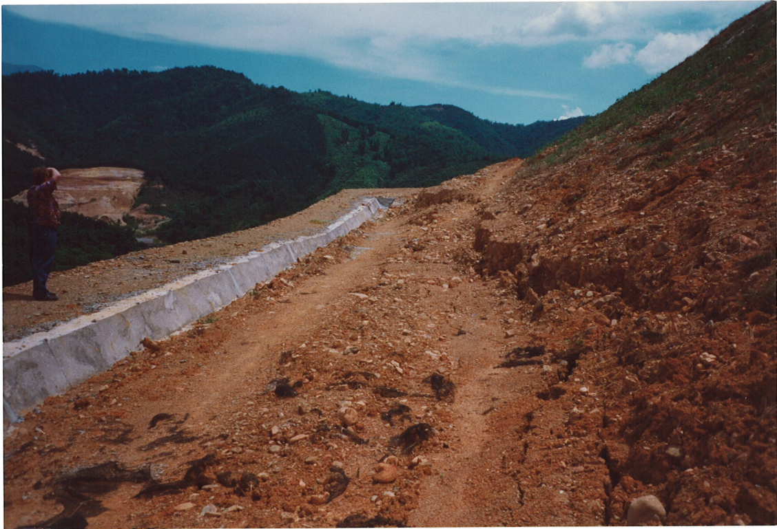
Bilde 32 Flere langsgående sprekker. Hva vil skje når disse sprekkene blir vannfylte ved neste store regnskyll?
