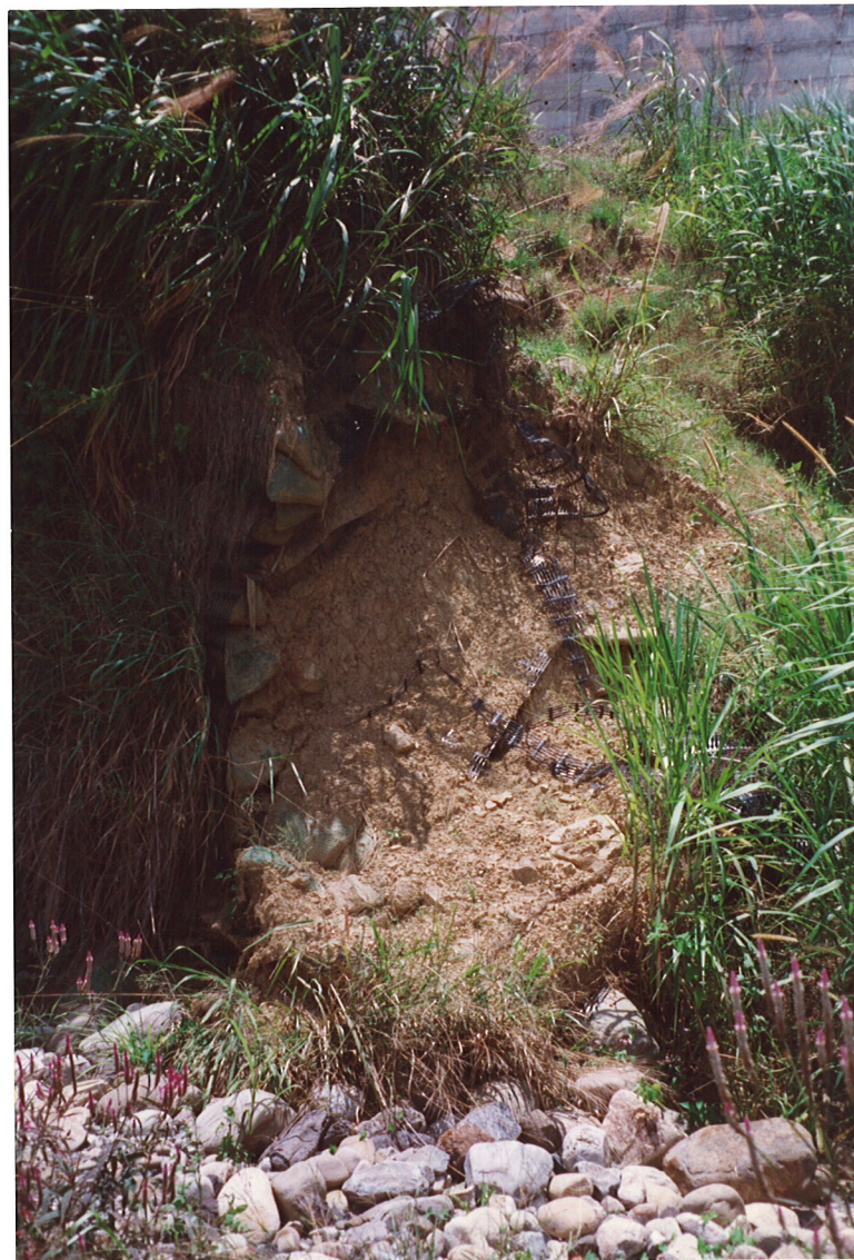
Bilde 17 Detalj av den sammenraste konstruksjonen. Sandfylte sekker har også vært brukt i fronten på denne skråningen
