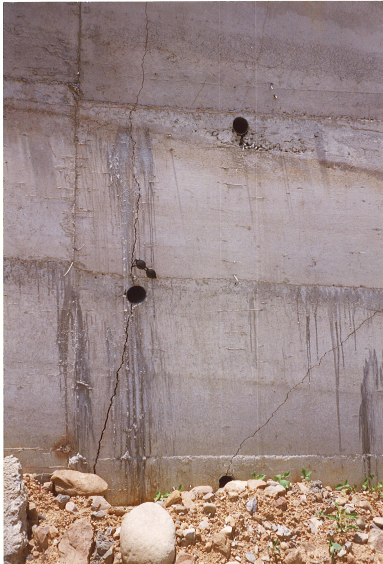
Bilde 14 Flere store sprekker i betongmuren
