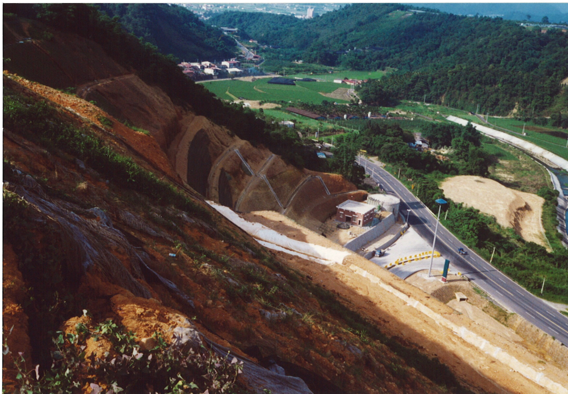
Bilde 33 Store erosjonsskader på toppen av skråningen. Merk at det er en 4-felts motorvei i bunn av den ustabile skråningen
