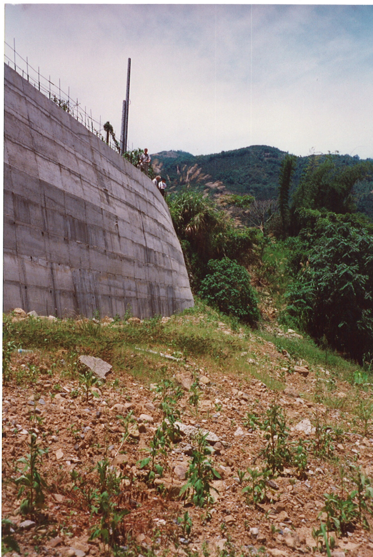
Bilde 13 Den øvre plasstøpte betongmuren buler på midten
