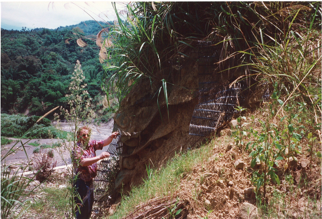
Bilde 16 Rester av den forsvunnede armert jord skråningen. En fullstendig sammenrast konstruksjon med Tensar geonett jordarmering
