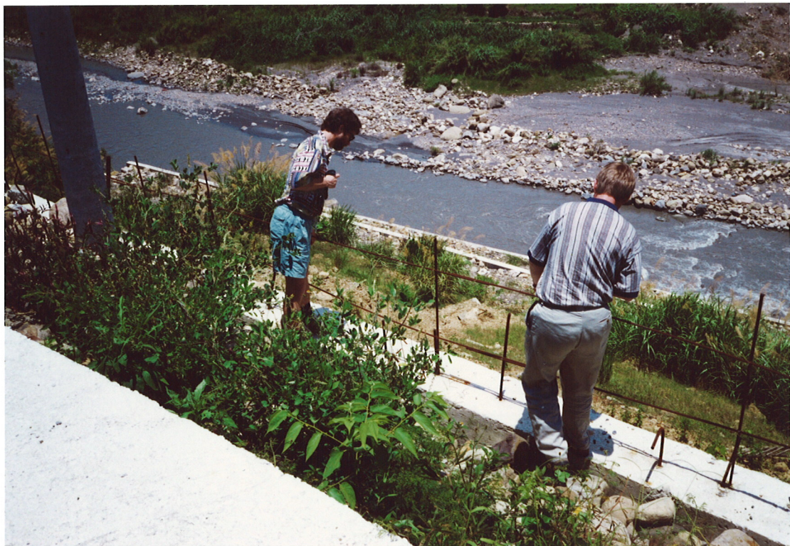
Bilde 21 Hvor lenge vil den sterkt påkjente betongmuren stå før den raser ut?
