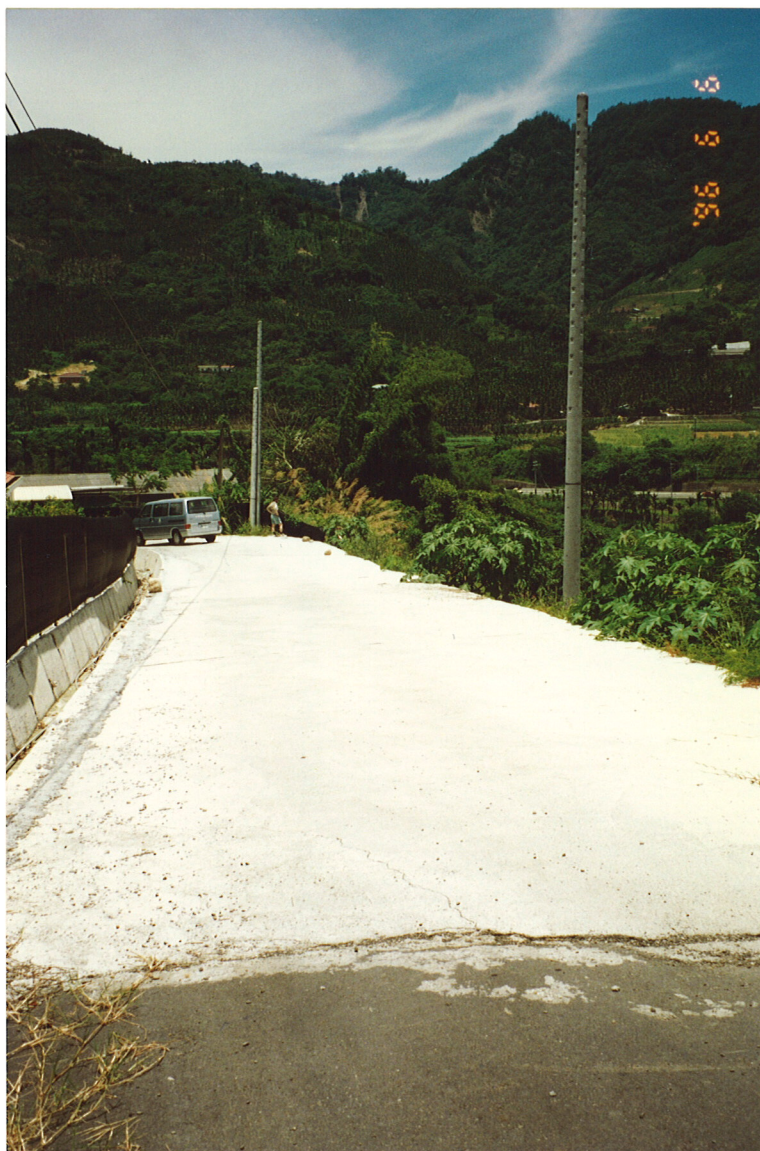
Bilde 12 Betongplate (med sprekker) på toppen av den øvre muren
