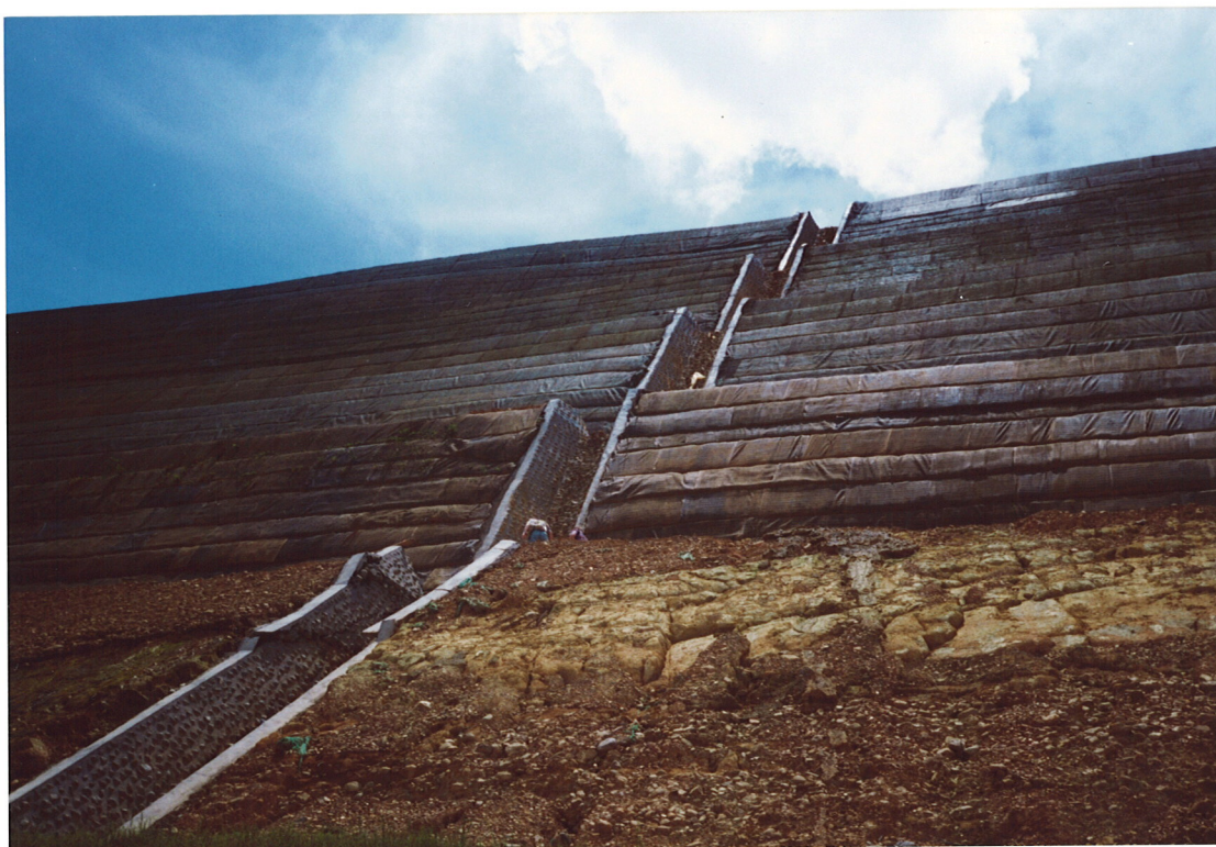
Bilde 26 Betongrenna har brudd på minst 2 steder
