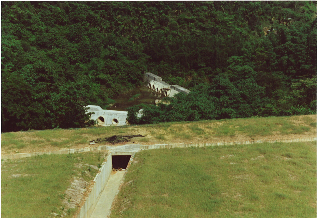
Bilde 42 Dreneringssystem med betongkanaler i den armerte skråningen, og midt på bildet sees dreneringssystemet i bunnen av dalen
