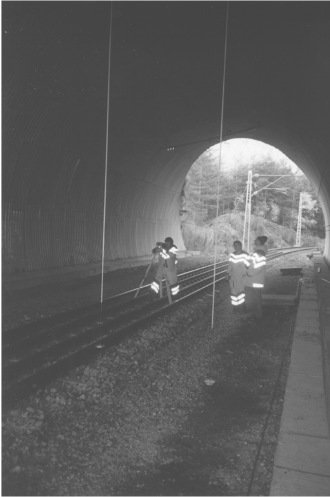
Figur 8 Målebånd for måling av deformasjoner
