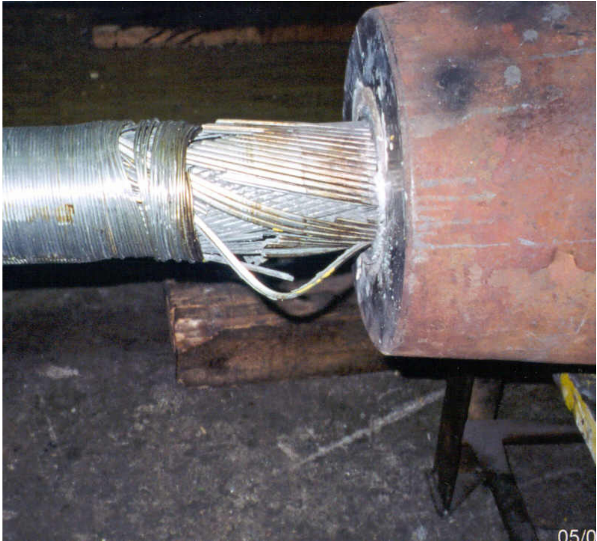
Foto 15. Trådbrudd ved kabelhodet.
