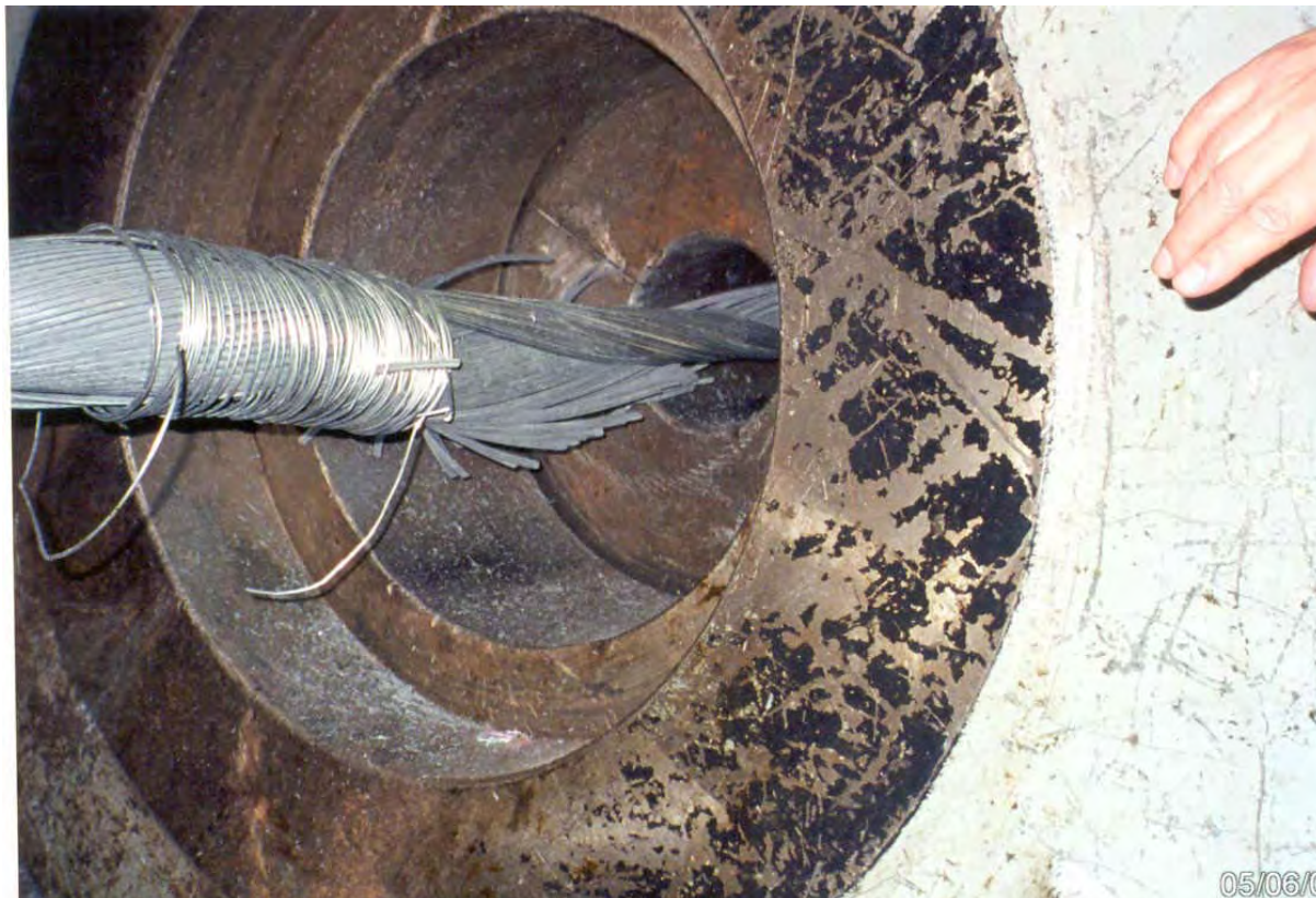
Foto 5. Brudd i kabelen.
