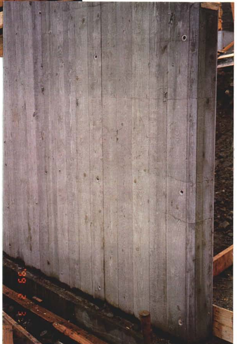
Foto 6 Søndre/nedre vegg, vestre parti. Synlige -florender ved enden av veggen
