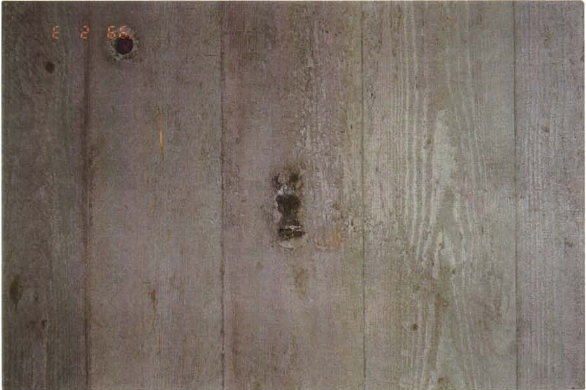
Foto 9 Sjøholt armeringsstol. Sementlim har ikke kommet mellom stolen og forskalingen
