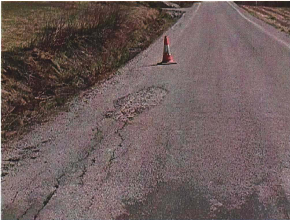
Frostsikring slutter ca. ved kjeglen, km 6,890. (Mai 1999)
