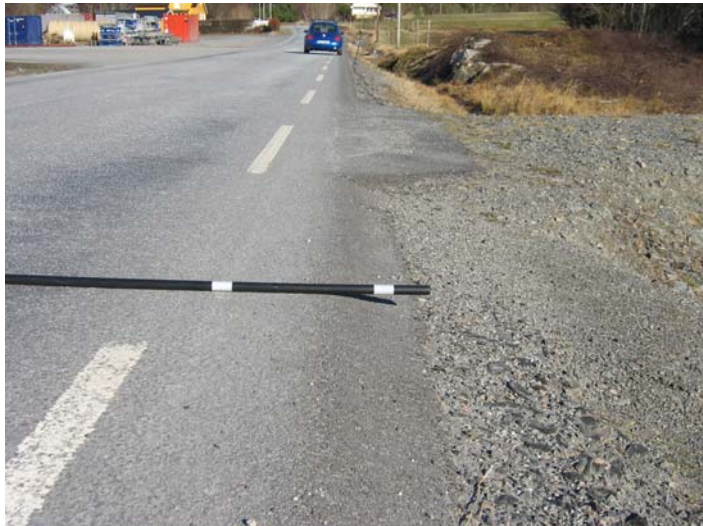
Fig. 23. Skrå asfaltkant på nylagt asfalt. Selv om kantlinjen merkes på ca 30 – 40 cm fra asfaltkanten, vil skråkanten representere risiko for ulykke dersom det ikke fylles opp med masse helt ut på vegskulderen.
