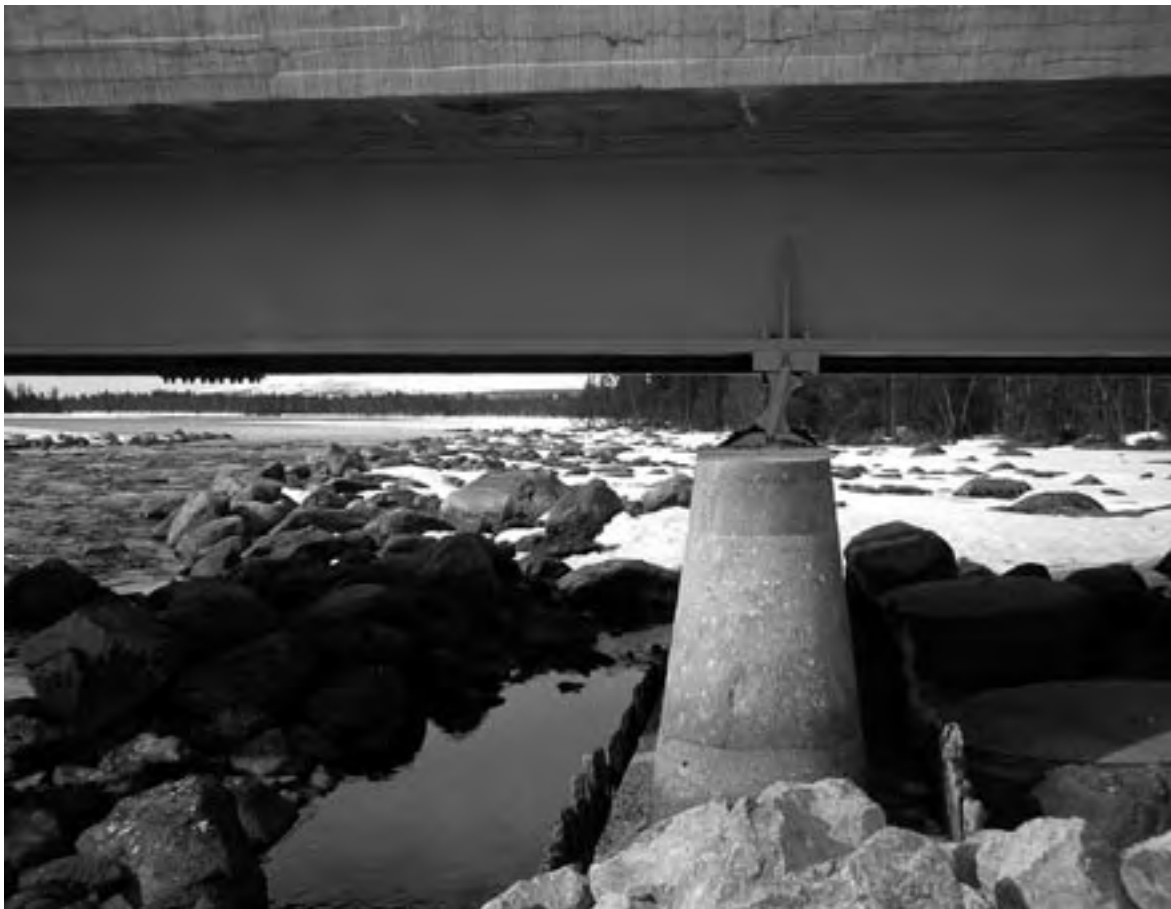
Figur 2: Isterfossen bru i Hedmark – forskyvning av pilar (Foto: Holger Lunde).
