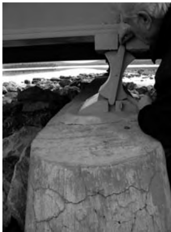
Figur 1: Isterfossen bru i Hedmark – forskyvning av pilar, måling av forskyvningens størrelse (Foto: Holger Lunde).
