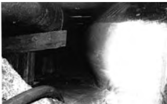
Figur 1: Plastfolien som deler kryprommet presses innover av en isfront.
