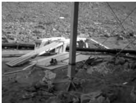
Figur 13: Viser en søyle og et fundament.
