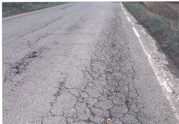
Storrutet krakelering, Alvorlighetsgrad H
