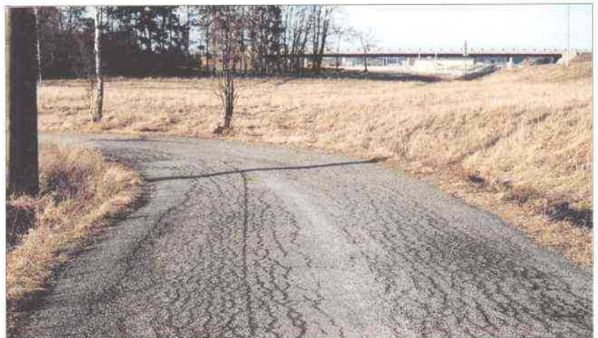
Figur 3 Asfaltering på vannømfintlig bærelag kan innebære krakelering etter første teletøsning
