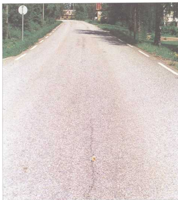
Langsgående telesprekk. Alvorlighetsgrad L
