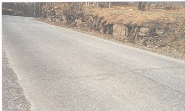
Sprekk, alvorlighetsgrad M
