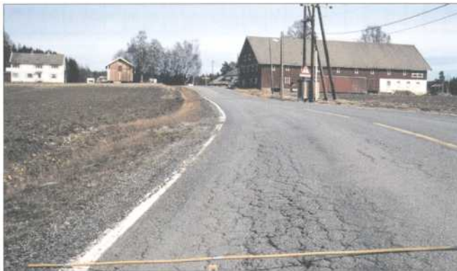
Spor pga. deformasjon, Alvorlighetsgrad H
