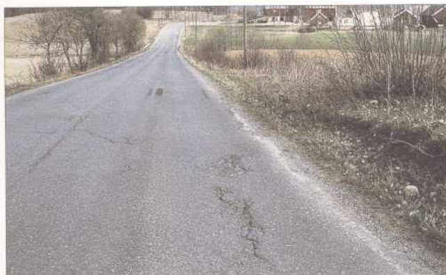
Langsgående sprekker uten entydig årsaksforhold, alvorlighetsgrad M
