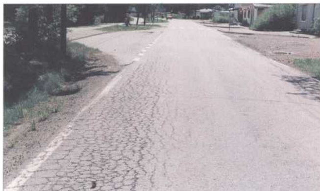
Smårutet krakelering, Alvorlighetsgrad M
