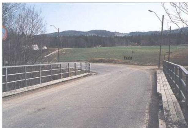
Sprekk, alvorlighetsgrad M
