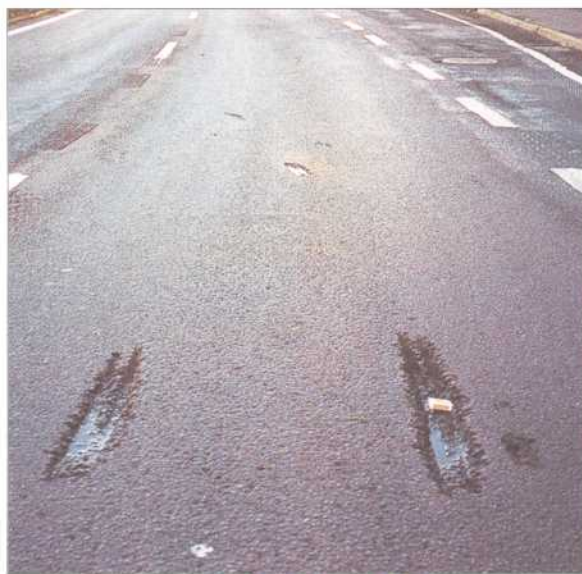
Mekanisk skade, Alvorlighetsgrad M
