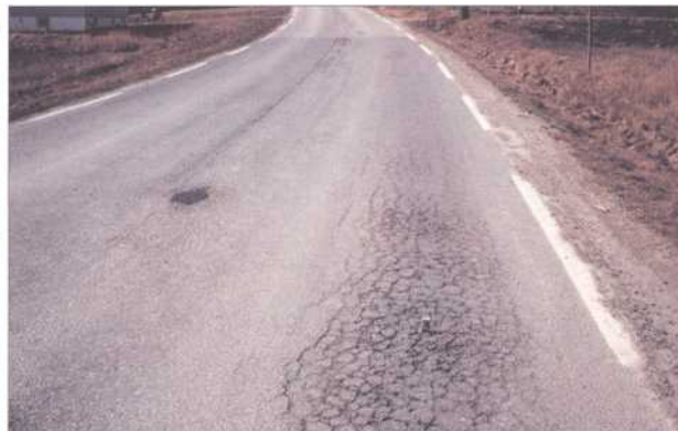
Smårutet krakelering, Alvorlighetsgrad H
