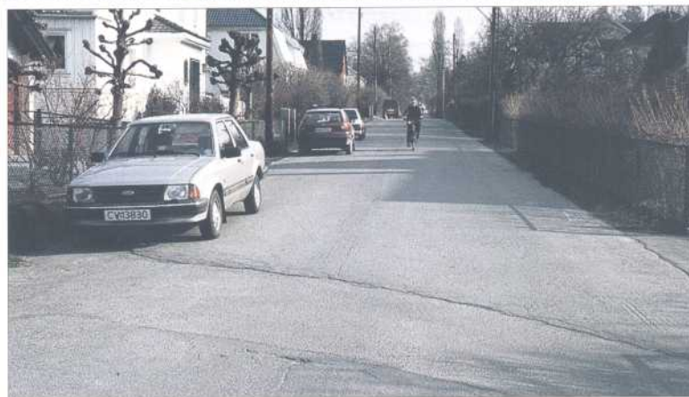
Sprekker etter gravearbeid, Alvorlighetsgrad M
