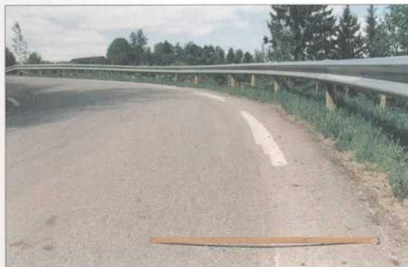
Spor pga. deformasjon, Alvorlighetsgrad M
