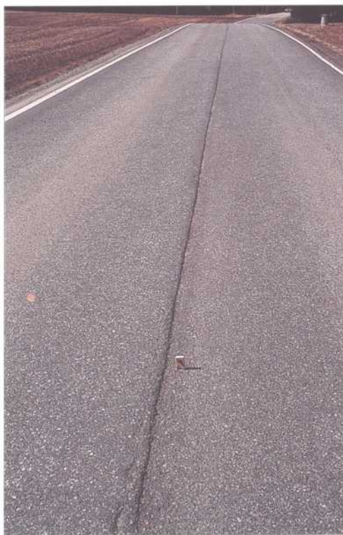
Åpen lengdeskjøt, Alvorlighetsgrad L
