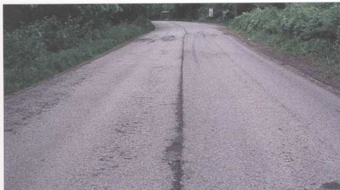
Åpen lengeskjøt, Alvorlighetsgrad L
