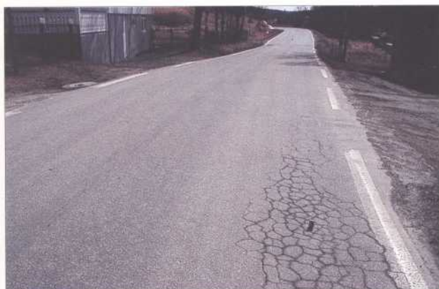
Storrutet krakelering, Alvorlighetsgrad M
