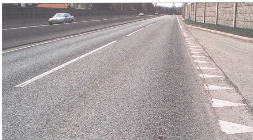
Ujevn overflate, Alvorlighetsgrad L
