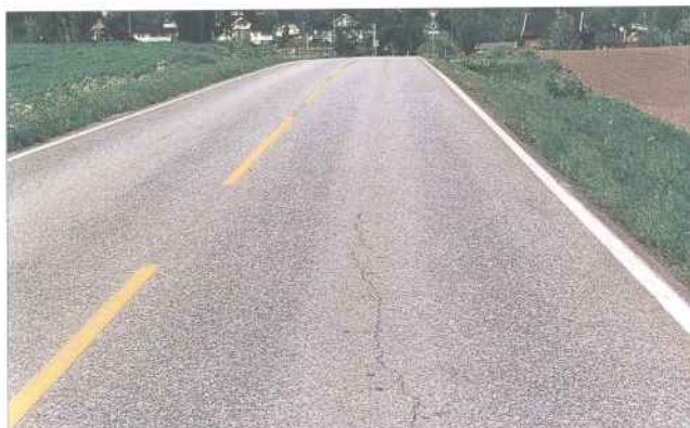
Langsgående telesprekk, alvorlighetsgrad L
