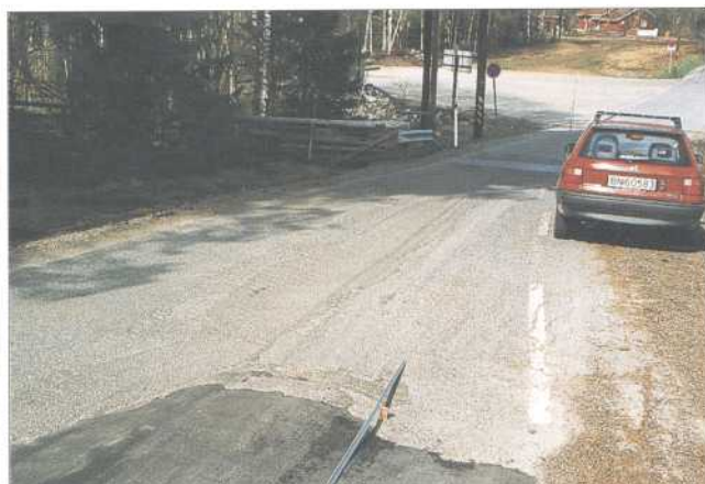
Lokalt ujevnt telehiv, Alvorlighetsgrad M
