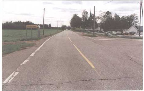
Svinnsprekk. alvorlighetsgrad H
