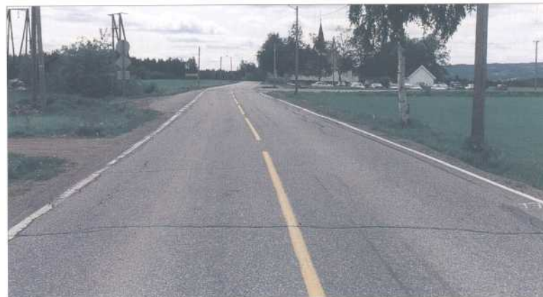
Svinnsprekk, Alvorlighetsgrad H
