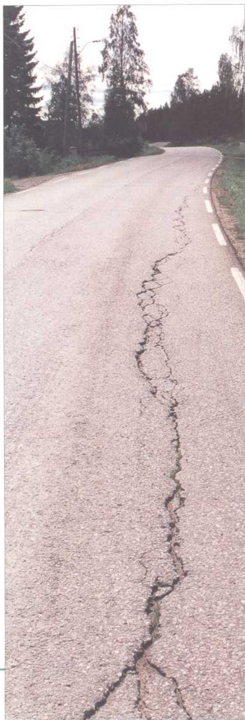
Kantsprekk. Alvorlighetsgrad H
