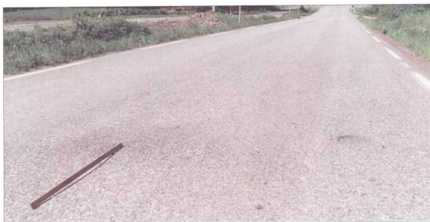
Ujevnt lengdeprofil, Alvorlighetsgrad L
