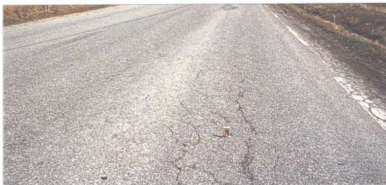
Storrutet krakelering, Alvorlighetsgrad L
