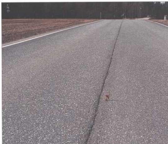
Åpen lengeskjøt, Alvorlighetsgrad H
