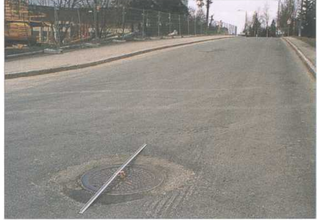
Lokale setninger, Alvorlighetsgrad M
