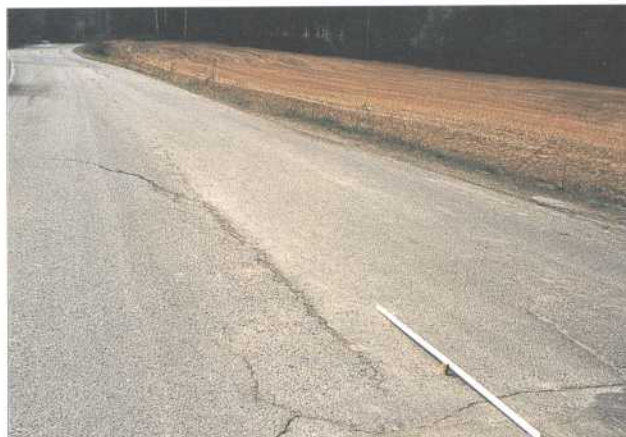
Lokalt ujevnt telehiv, Alvorlighetsgrad L
