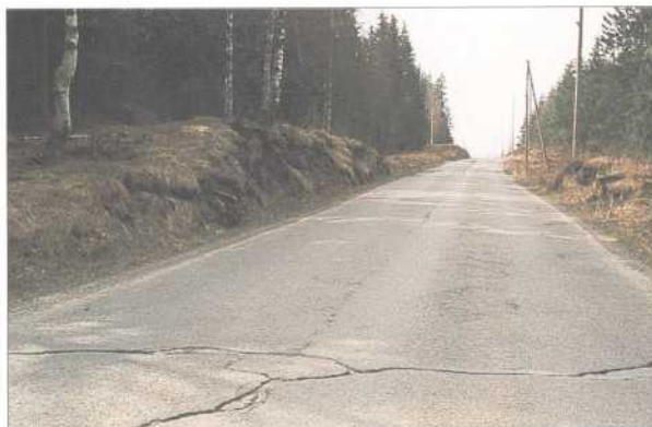
Sprekk, alvorlighetsgrad H
