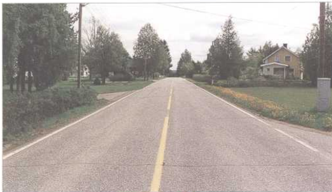
Svinnsprekk. alvorlighetsgrad M
