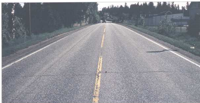
Svinnsprekk, Alvorlighetsgrad L
