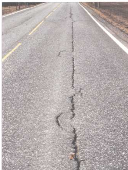
Sprekk pga. breddeutvidelse, alvorlighetsgrad M
