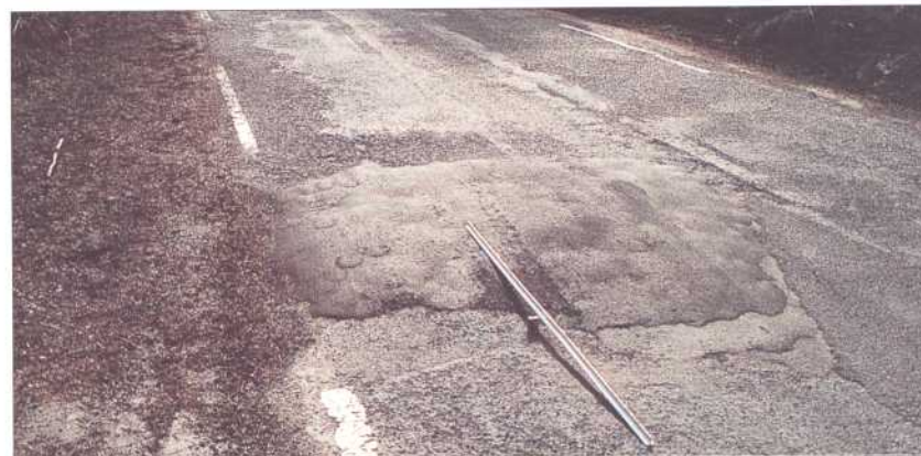
Ujevnt lengdeprofil, Alvorlighetsgrad H
