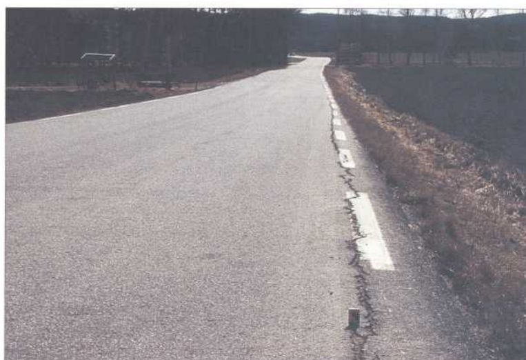
Kantsprekk, alvorlighetsgrad M
