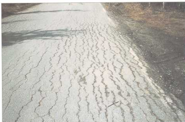
Langsgående sprekker uten entydig årsaksforhold, alvorlighetsgrad H
