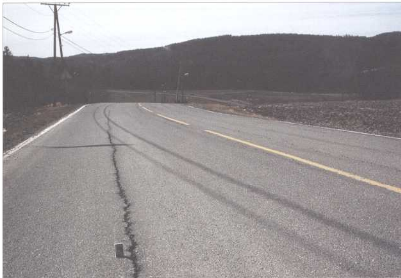
Sprekk pga. breddeutvidelse, alvorlighetsgrad M
