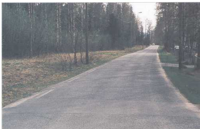
Sprekk, alvorlighetsgrad L
