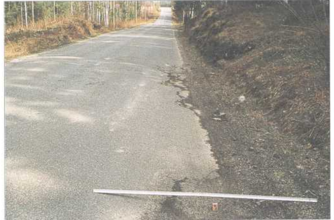
Kantdeformasjon, Alvorlighetsgrad H
