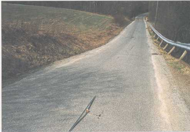
Ujevnt lengdeprofil, Alvorlighetsgrad L
