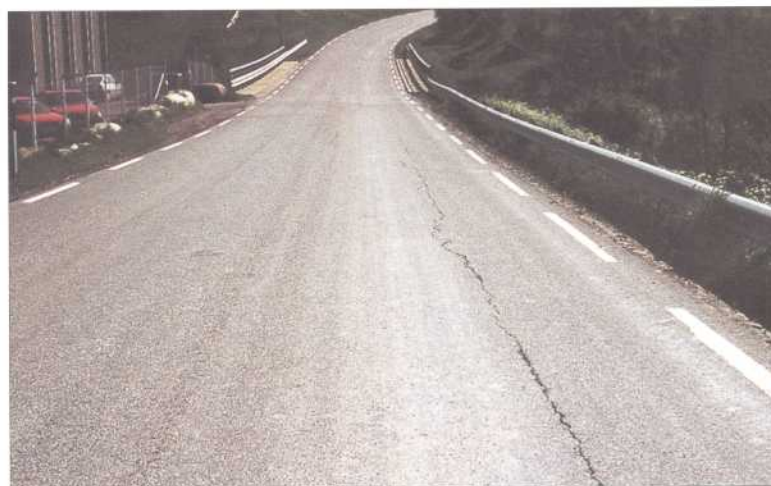
Sprekk pga. breddeutvidelse. Alvorlighetsgrad M
