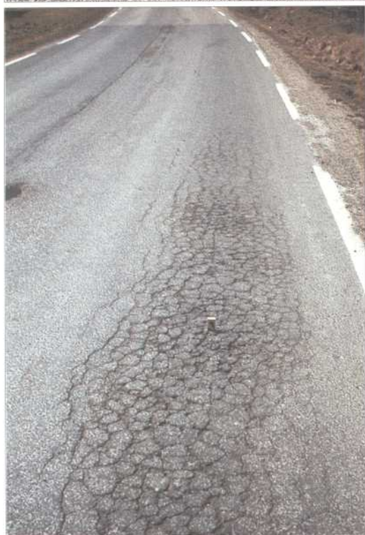
Smårutet krakelering, Alvorlighetsgrad H
