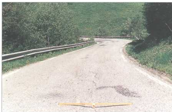
Spor pga. deformasjon, Alvorlighetsgrad M
