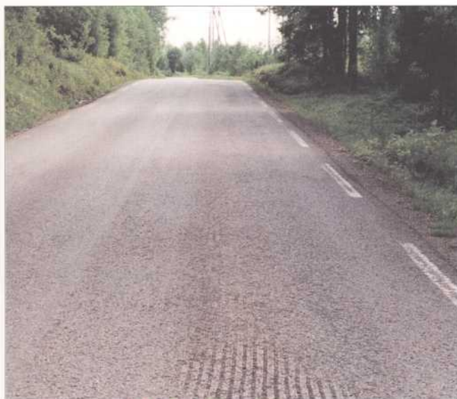
Mekanisk skade, Alvorlighetsgrad L
