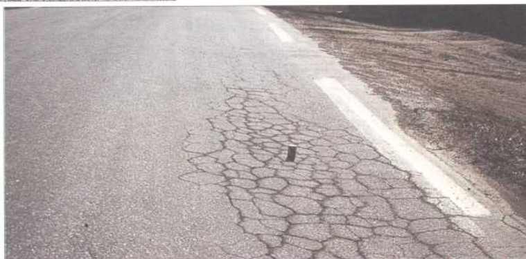
Smårutet krakelering, Alvorlighetsgrad M
