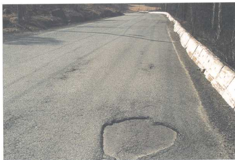
Slaghull, Alvorlighetsgrad H
