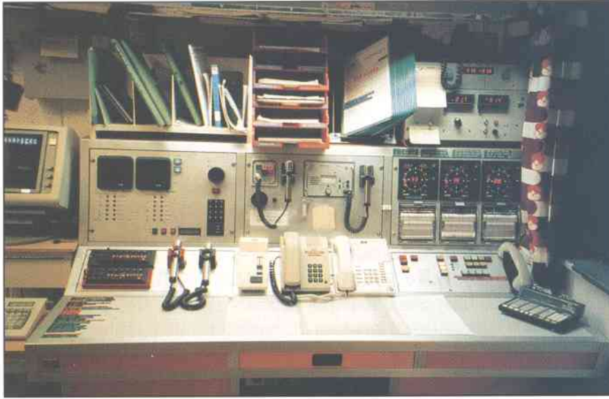
Figur 4.1 Overvåkings- og værobservasjonssentral for Haukelifjellet.
