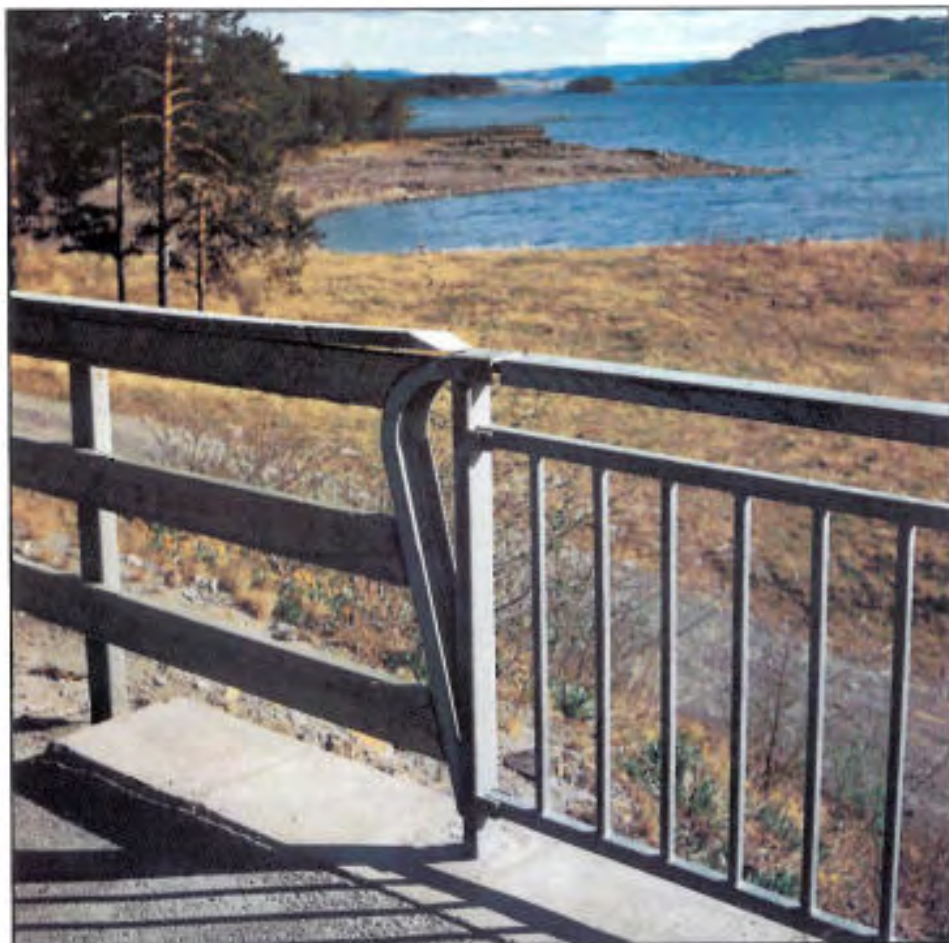
Dette rekkverket er lappet på i flere omganger. Resultatet blir preget av tilfeldigheter. Håndverkeren har gjort sitt beste, men med feil utgangspunkt hjelper det ikke.
