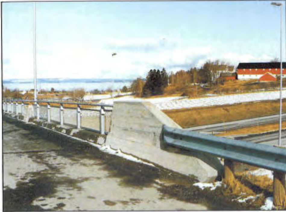
Overgangsbru E6, Ranheim, Sør-Trøndelag, 1987. Rekkverksdetalj på bru som passerers i høy hastighet.
