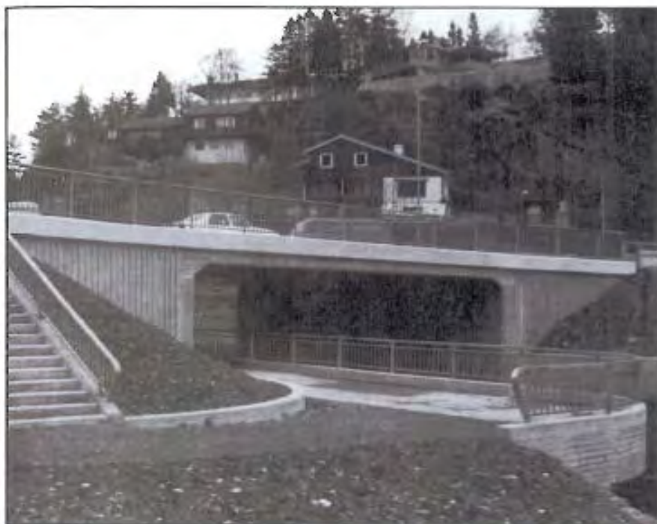
Undergang ved Sælenvatnet, Hordaland, 1987. God utforming med forseggjorte detaljer og terrengbehandling. Overgangen fra brurekkverket til vegrekkverket ødelegger helhetsinntrykket.
