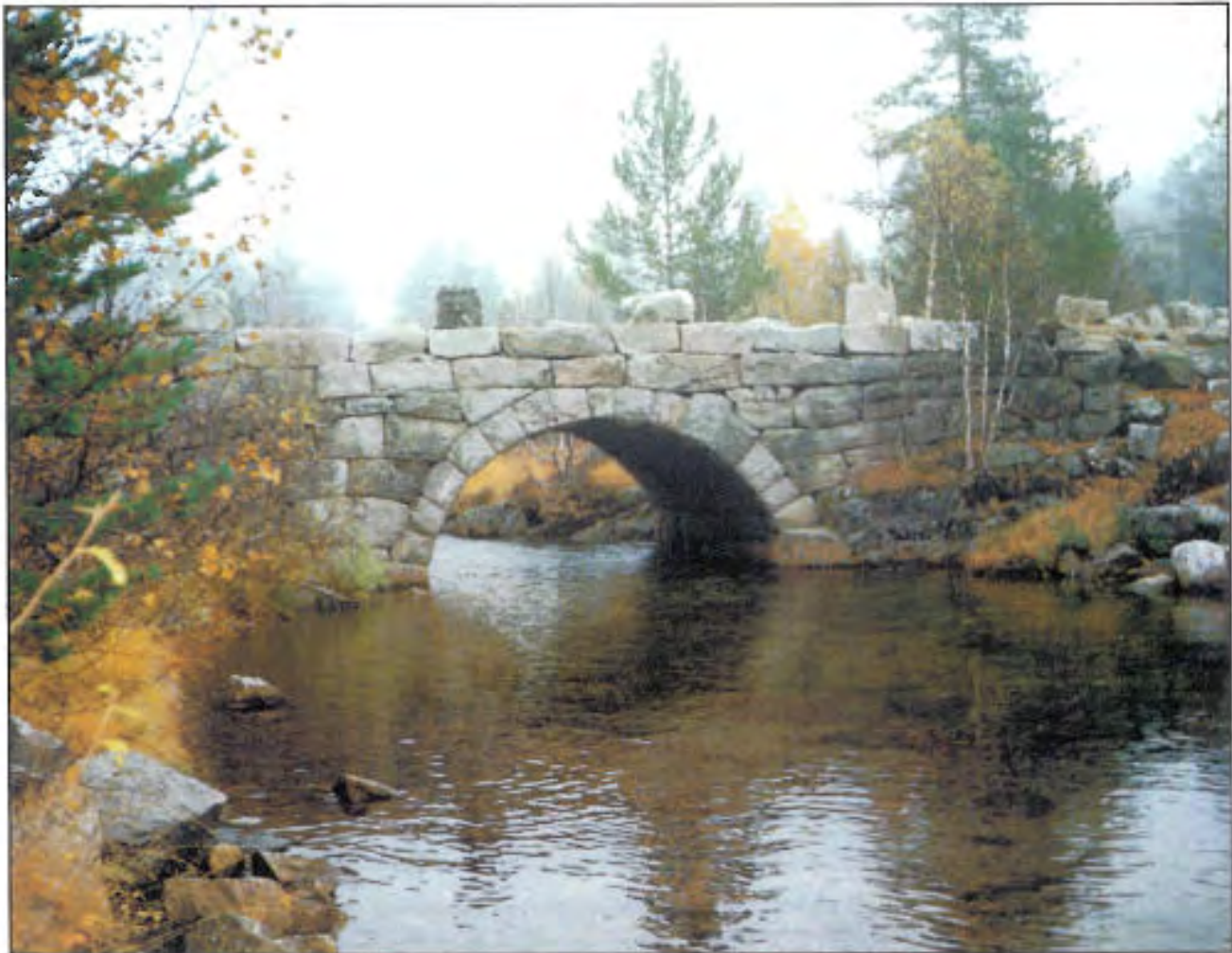
Tverråne bru, Bykle, Aust-Agder. Bygd like etter 1900. Brua er ute av bruk i dag, men er fremdeles i god stand.
