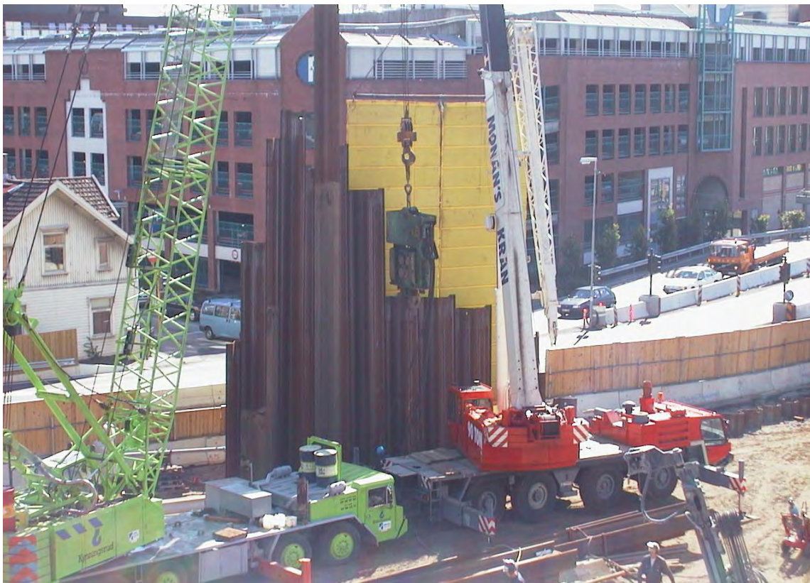
Figur 18.4 Støyskjermende tiltak E 18 Kristiansand, Banehagen tunnelportal
