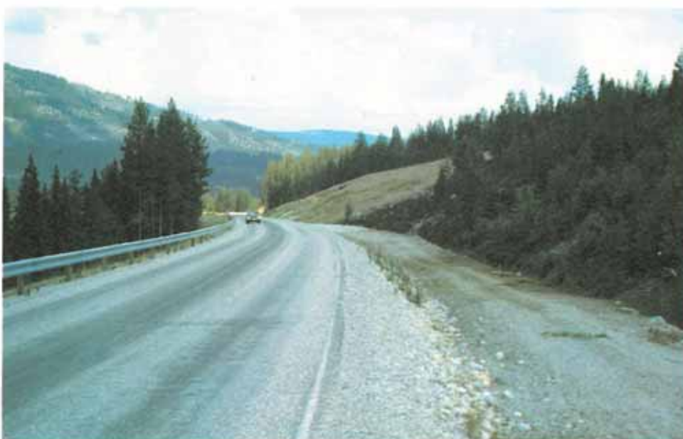
Den samme skråningen som ovenfor tre år senere. Gresskledningen har ikke greidd å stabilisere skråningen. Planting av trær i tillegg til en foreløpig gresskledning ville gitt en bedre situasjon.
